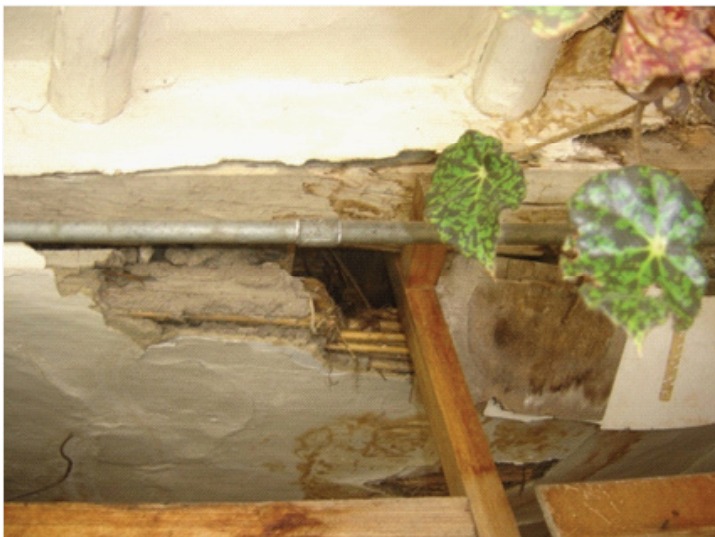
Daños en el cielo raso, casa Arizaga, Cuenca 2010
