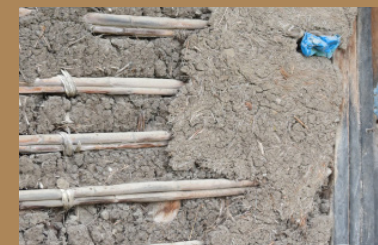
figura 142. Desprendimiento-revoque* Gualaceo - Azuay
