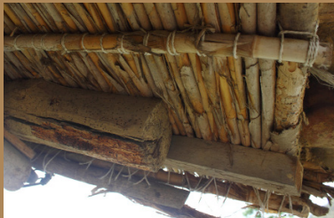
figura 131. Hongos en techo* Paute - Azuay
