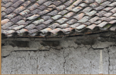
figura 138. Fisura del tabique* Gualaceo - Azuay
