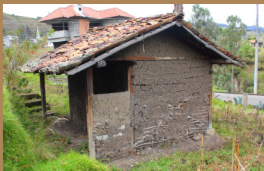
figura 117. Vivienda abandonada* Sigsig - Azuay
