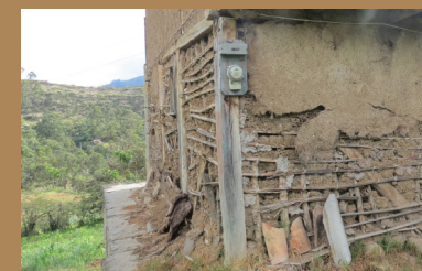
figura 32. Desprendimiento* Azogues - Cañar
