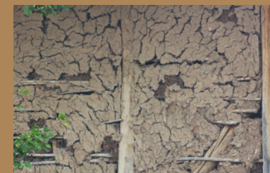
figura 31. Fisuras* Azogues - Cañar
