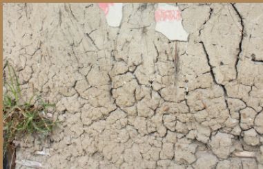
figura 124. Fisuras* Gualaceo - Azuay
