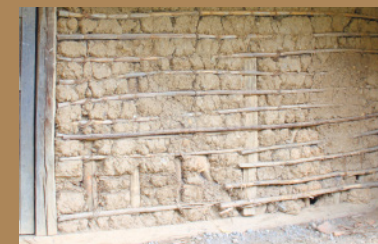
figura 144. Pérdida del material* Paute - Azuay
