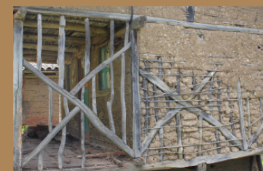
figura 145. Pérdida total material* Paute - Azuay
