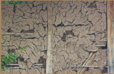
figura 114. Deterioro de paredes* Azogues - Cañar
