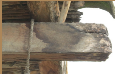
figura 42. Manchas en la madera* Defectos por la humedad
