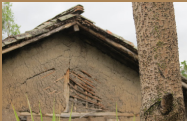
figura 140. Grietas en tímpano* Gualaceo - Azuay
