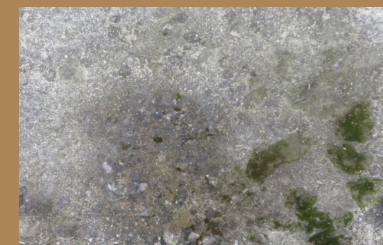
Figura 126. Humedad de piso* Gualaceo - Azuay
