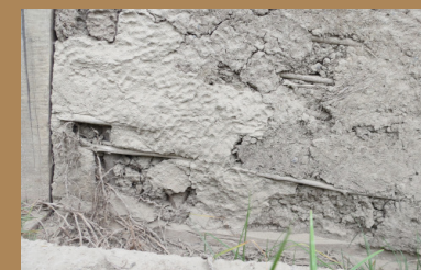
figura 137. Agrietamiento masivo* Chordeleg - Azuay
