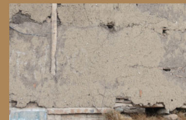
figura 134. Asentamiento cimiento* Gualaceo - Azuay
