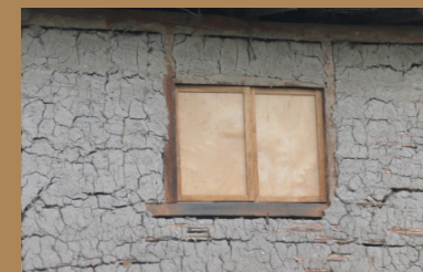
figura 136. Fisura de revoque* Chordeleg - Azuay
