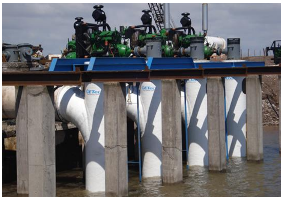
Figura 2-5. Estación de bombeo [13].
