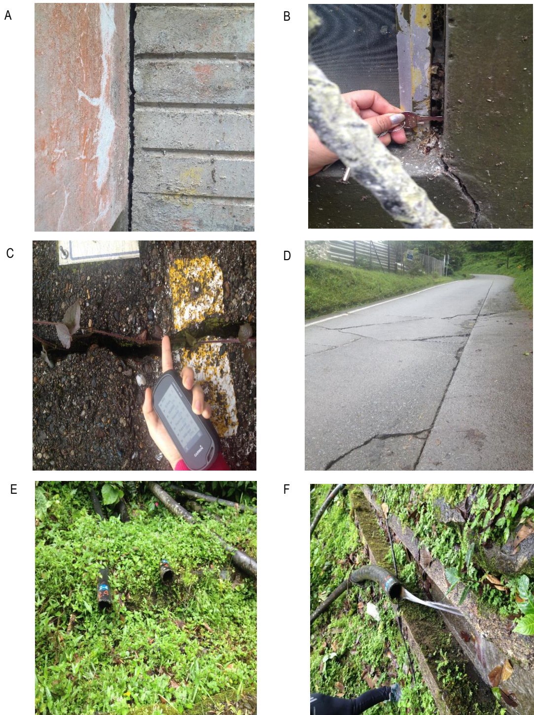
FOTO A7.2: A y B, separación entre las paredes de las oficinas del campamento. C, fisura en el muro de una de las habitaciones del campamento. D, fisura ubicada en la vía, cerca del área de mantenimiento del campamento. E y F, drenes colapsados por movimientos y drenes en correcto funcionamiento, respectivamente.
