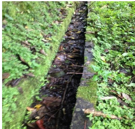
FOTO A6: Problemas en cunetas. A, B, C y D, fisuras en la cuneta que provocan infiltración y asentamientos. E, falta de limpieza en la cuneta, obstrucción por la presencia de vegetación.
