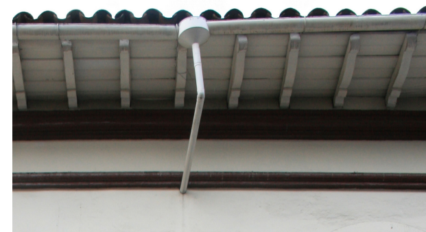
FIG. 119. Canal y bajante de hojalata en una casa del centro histórico de Cuenca.
