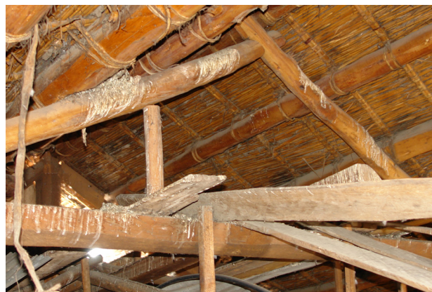
FIG. 36. Estructura de la Cubierta en Edificio de la Sociedad de Obreros de la Salle (1917). La madera era el material principal para la conformación de este tipo de estructuras.
