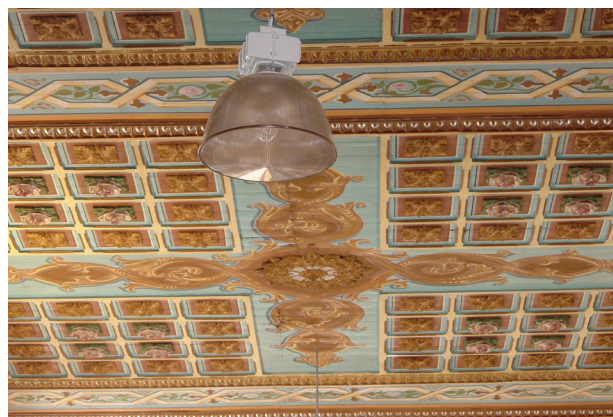
FIG. 51. Pintura tabular en cielorraso del edificio Sociedad Obreros de la Salle. La moda del latón impulsó a que se produzca este tipo de imitaciones.
