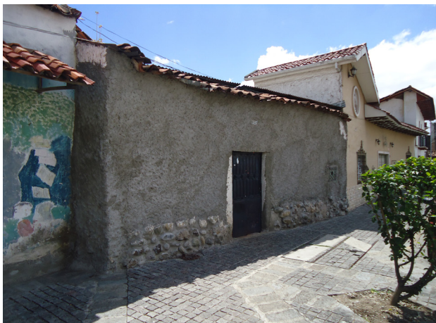
FIG. 11. Pared de adobe enlucida con mortero de cemento. Este es un gran ejemplo de la afección que puede provocar la incorporación de nuevos materiales en las construcciones tradicionales
