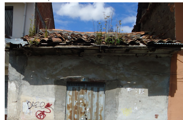
FIG. 13. Vivienda del Centro Histórico de Cuenca. El abandono y la mala incorporación de materiales que son incompatibles con la arquitectura tradicional, pone en riesgo la conservación de este tipo de bienes.
