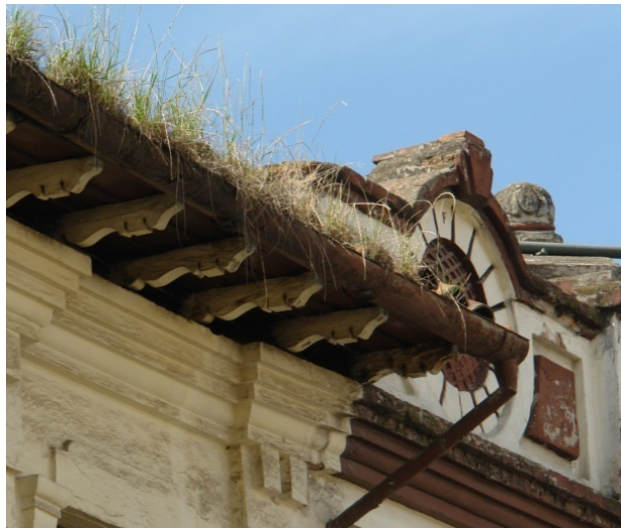
FIG. 24. Fotografía de un daño registrado en la cubierta de una edificación patrimonial de la ciudad.
