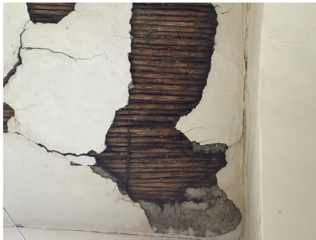
FIG. 21. Daño en cielo raso, registrado en la etapa de diagnóstico de la Antigua Escuela San José
