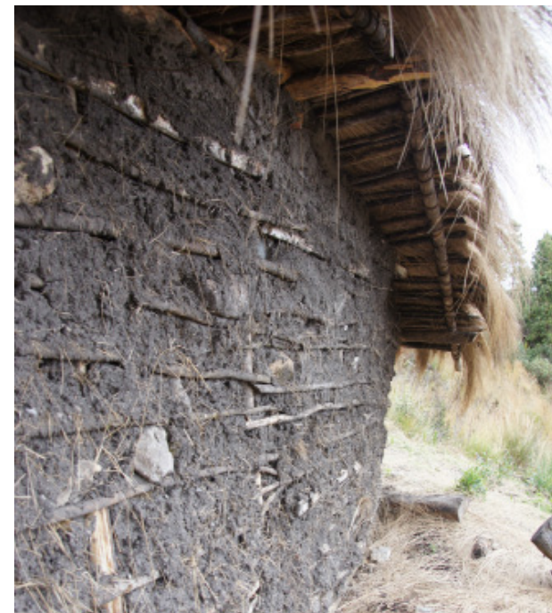
FIG. 33. Conformación de las paredes de bahareque, cubierta de madera - paja de la arquitectura Cañari
