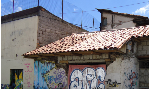
FIG. 10. Ejemplo de incompatibilidad y daños sobre los materiales. Pared de adobe afectada por pinturas y contraste con bloques de cemento.
