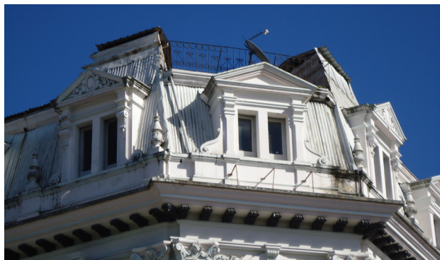
FIG. 71. Antigo Hotel Internacional (1927-1935). Se puede observar el uso de zinc para la conformación de la cubierta.
