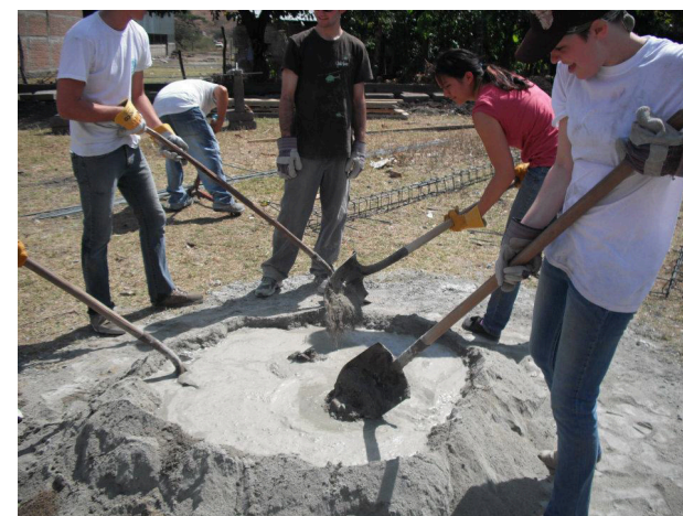
FIG. 105. Proceso de mezcla del cemento y áridos para la elaboración de hormigón.
