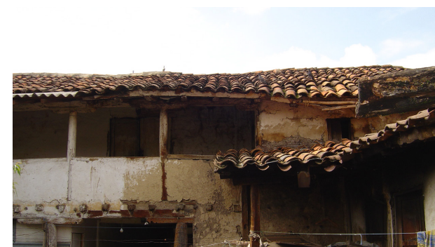
FIG. 8. Vista interior de la “Casa de las Posadas” antes de su restauración, Cuenca. El deterioro de los materiales puso en riesgo la existencia de esta edificación
