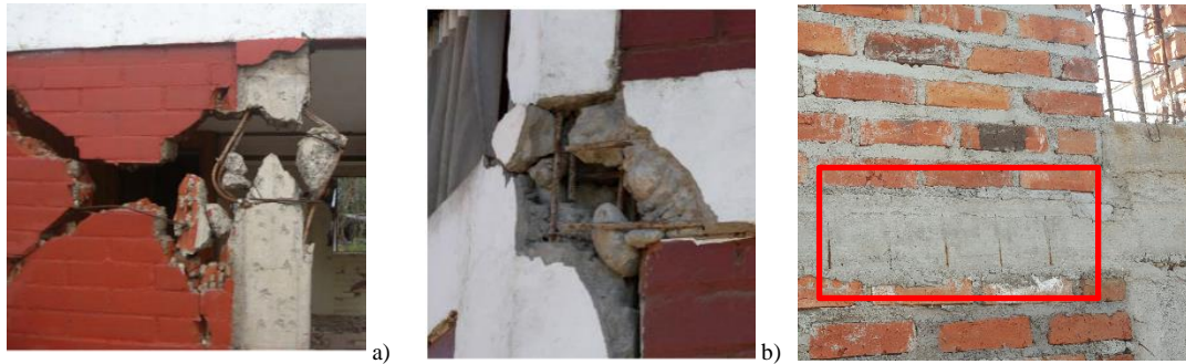
Figura 4. Fallas por mal detallado del refuerzo: a) Falla por cortante y pandeo del refuerzo longitudinal debido a separación de estribos excesiva en los extremos de la columna de confinamiento; b) falla por discontinuidad de refuerzo longitudinal (Tomado de Brzev et al., 2010), y c) exposición del refuerzo debido a recubrimiento inadecuado en una edificación en Cuenca.
