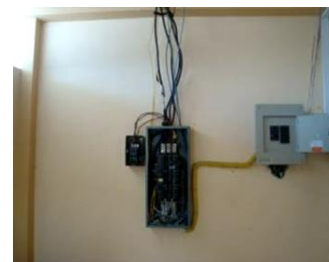
FOTO 4.4.2. A. Área De Suministro Eléctrico
