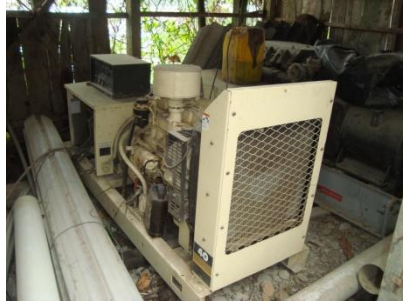
Foto 5.1.A Generadores Nuevos En Un Lugar No Adecuado
