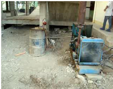
Foto 3.2.3.7.B. Almacenamiento De Combustible Para El Generador De Luz
