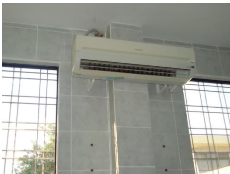
Foto 3.2.3.8.B. Sistema De Ventilación Utilizado En Laboratorio
