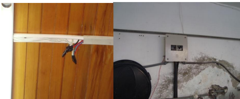
Foto 3.2.3.16.D. Deficiencia De Las Instalaciones Eléctricas
