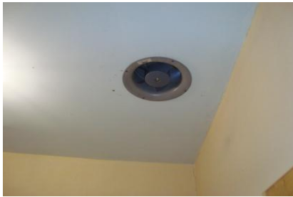
FOTO 3.2.3.2.D. Sistema De Ventilación Sala De Revelado
