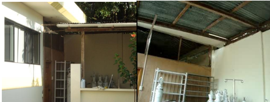
Foto 3.2.3.15.C. Estado Del Área De Almacenamiento De Gases Comprimidos
