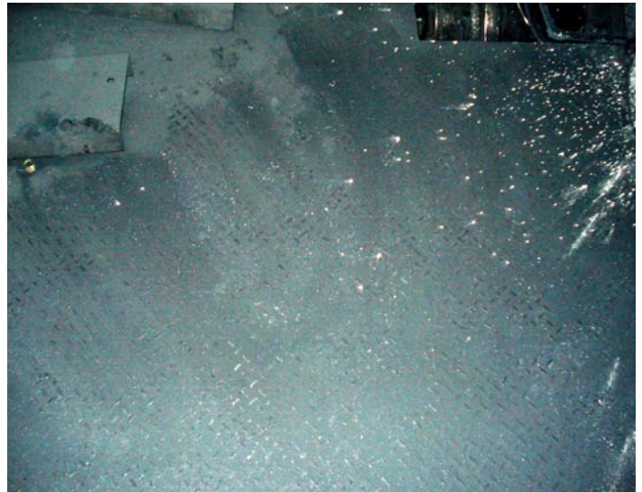
Fig.2.2 Suciedad en pisos.
