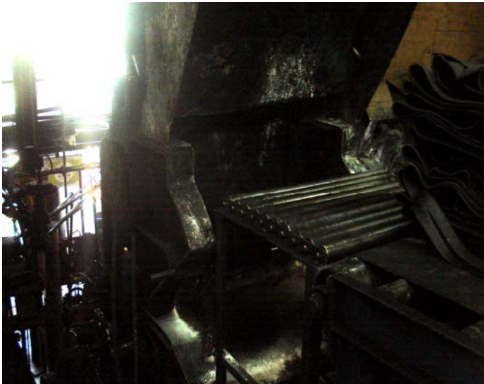
Fig.2.1 Suciedad en maquinaria.
