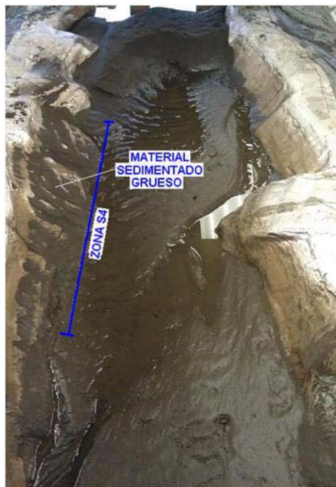
Figura 4.4.3: Material sedimentado en el margen derecho aguas arriba (Zona S4)
