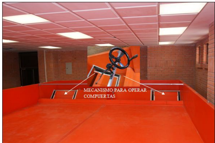
(d) Mecanismo de operación para las compuertas
