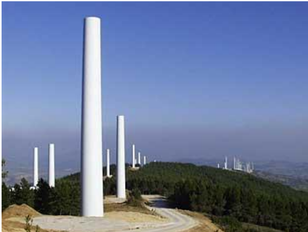
Figura 3. 9 Torres tubulares de acero
