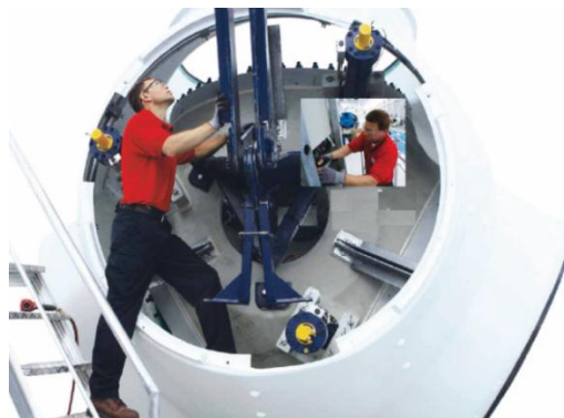
Figura 3. 15 Detalle del buje de una turbina eólica
