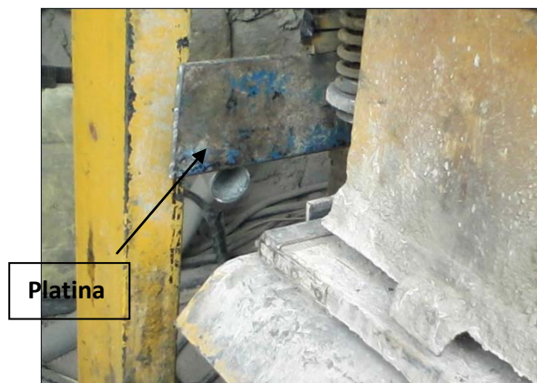
Figura 3.15. Platina de protección del sensor de proximidad de tablas.
