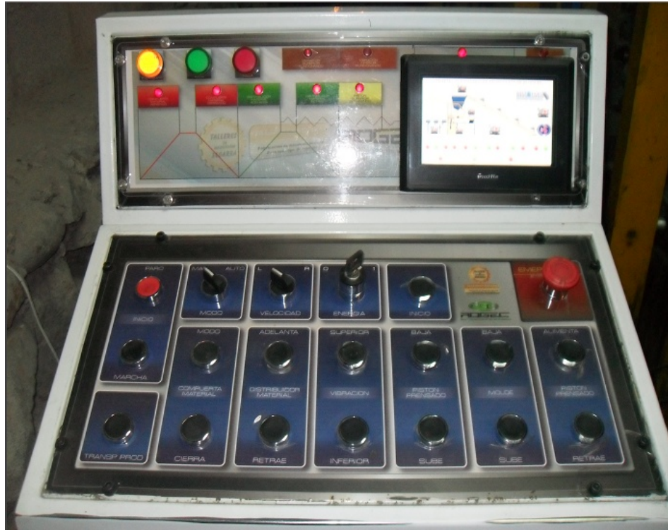
Figura 3.40. Tablero de Control incluido el HMI.
