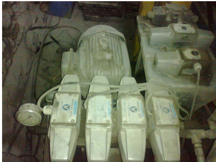
Figura 1.16. Conjunto de Electroválvulas.
