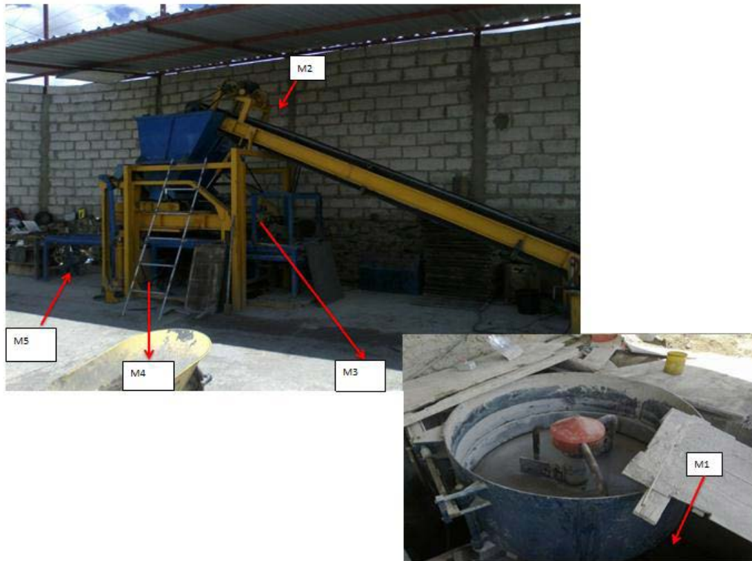
Figura 1.15. Distribución de motores eléctricos en la máquina bloquera.
