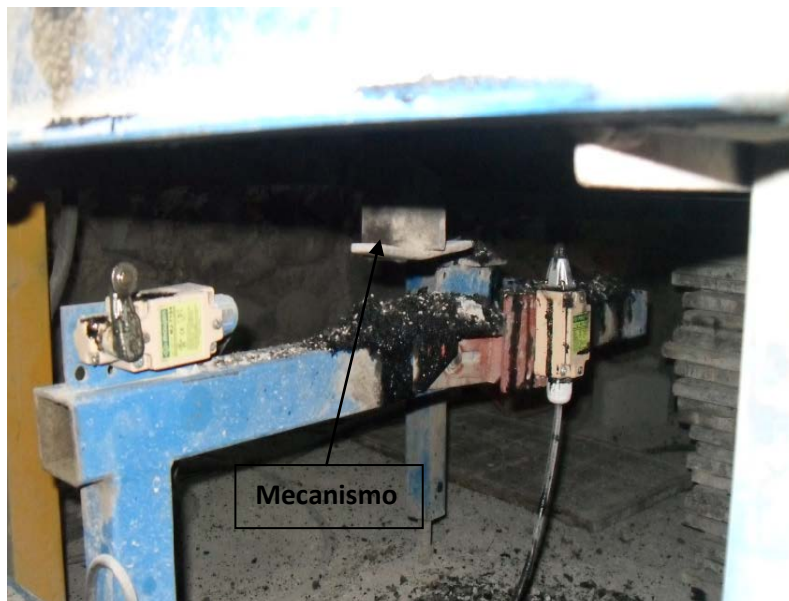
Figura 3.12. Mecanismo que activa y desactiva los sensores de posicionamiento de tablas.
