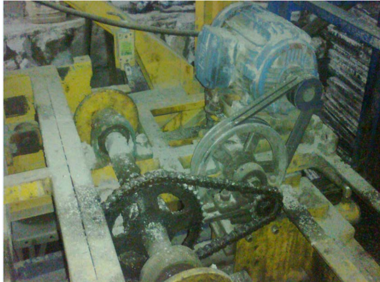
Figura 1.29. Motor que mueve paletas del dosificador.
