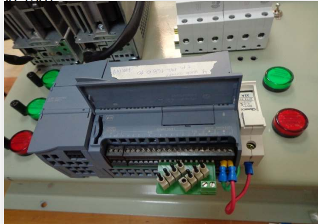
FIG.138 Conexión de la alimentación de los PLC'S
