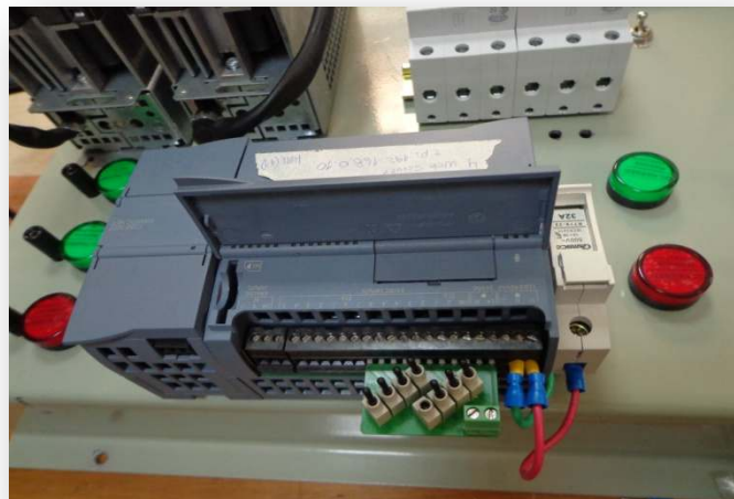
FIG.131 Montaje de los PLC's S7-1200 y Switch
