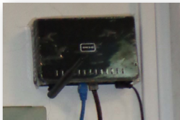
FIG.137 Montaje del Router
