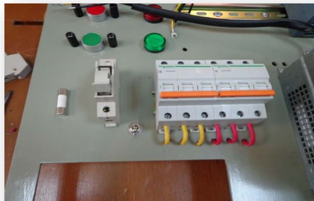
FIG.129 a) Portafusible y fusible de 6 amp; b) Breakers Tripolares de 6 amp
