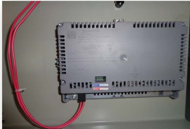
FIG.140 Conexión de la alimentación de los HMI'S
