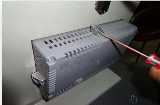
FIG.130 Montaje de los HMI's KTP600
