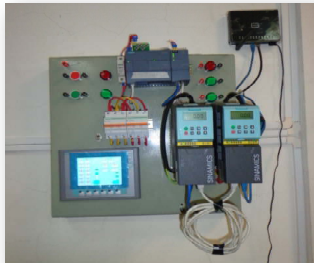
FIG.133 Panel instalado en la pared del aula multimedia
