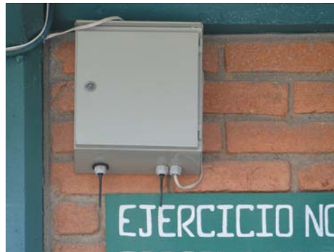
Figura 4.23: Acces Point ubicado en el bloque A – 2do piso
