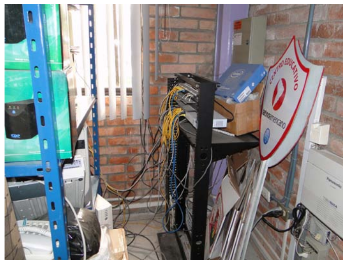
Figura 4.9: Interior del Centro de datos
