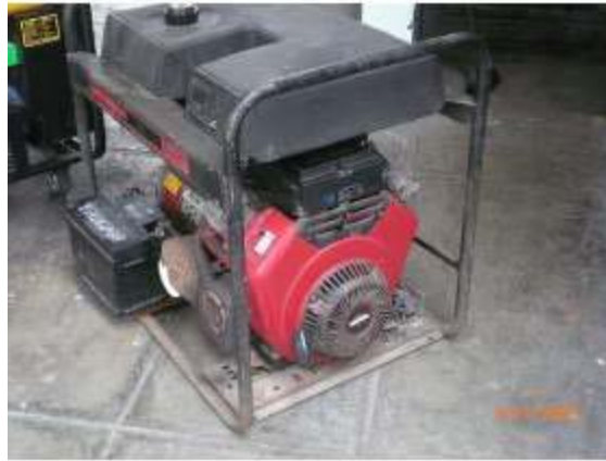
Figura 4.14: Generador de respaldo
