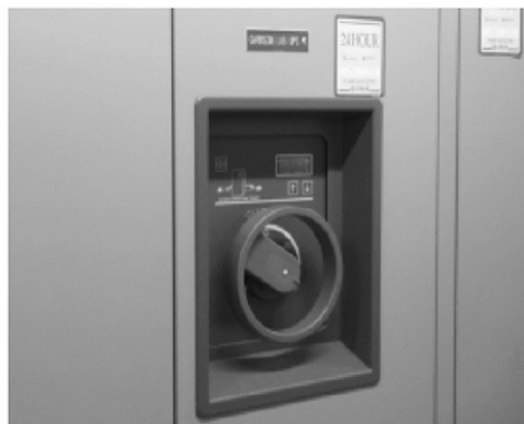
Figura 2.9: Panel de Control de un sistema de UPS
