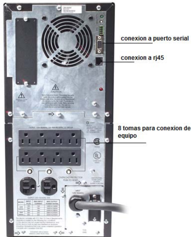
Figura 4.36: APC Smart-UPS 2200VA Vista Posterior
