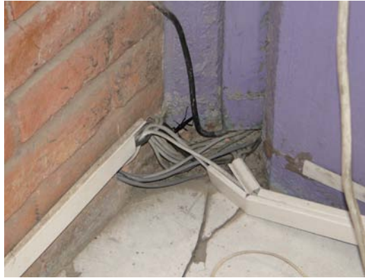
Figura 4.17: Estado del cableado
