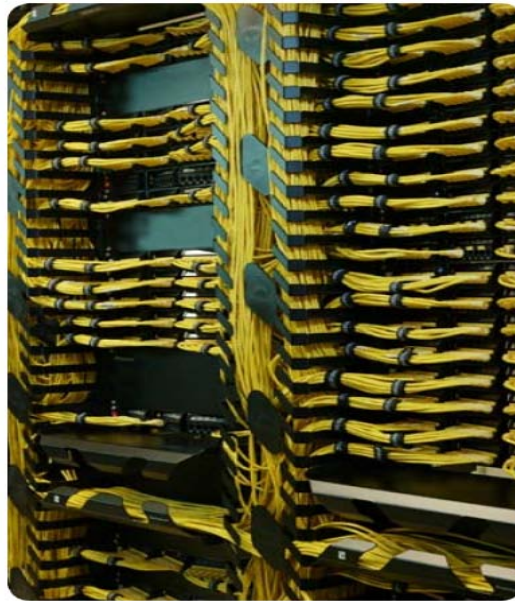
Figura 3.12: Disposición del cable dentro del Rack
