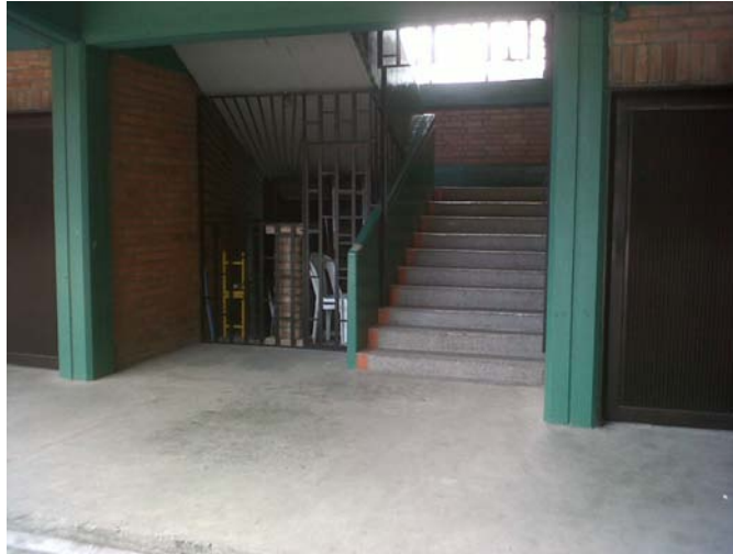
Figura 4.37: Lugar destinado a ubicarse el generador
