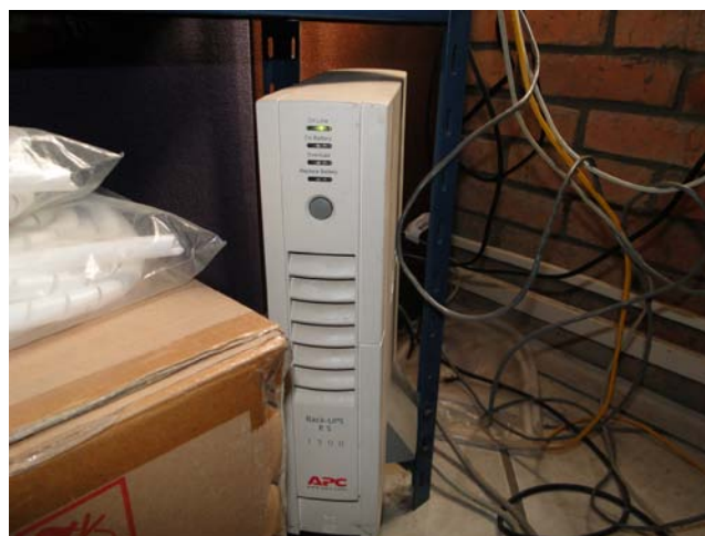
Figura 4.13: UPS de respaldo de los servidores
