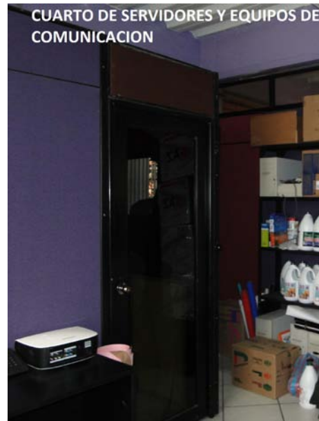
Figura 4.8: Cuarto de Servidores
