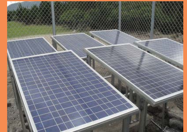
FOTO 1.14: Paneles solares, petroecuador.
