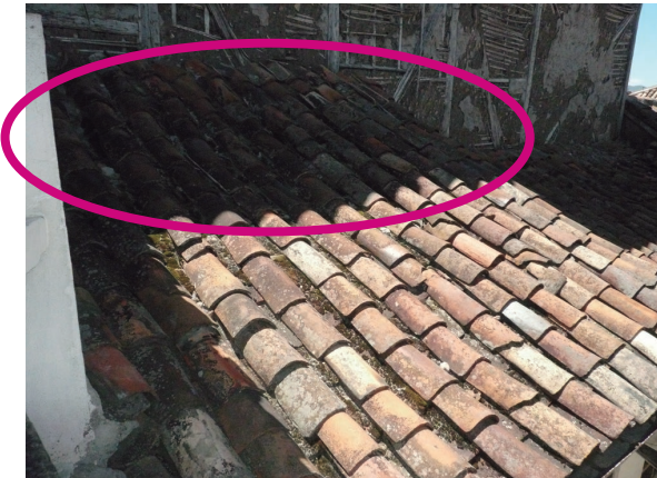
Figura 73 Pandeo en Cubierta de teja Fuente: Gabriela Bolaños Sánchez
