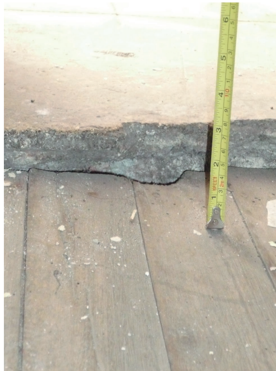
Figura 69 Hundimiento en piso de madera Fuente: Gabriela Bolaños Sánchez
