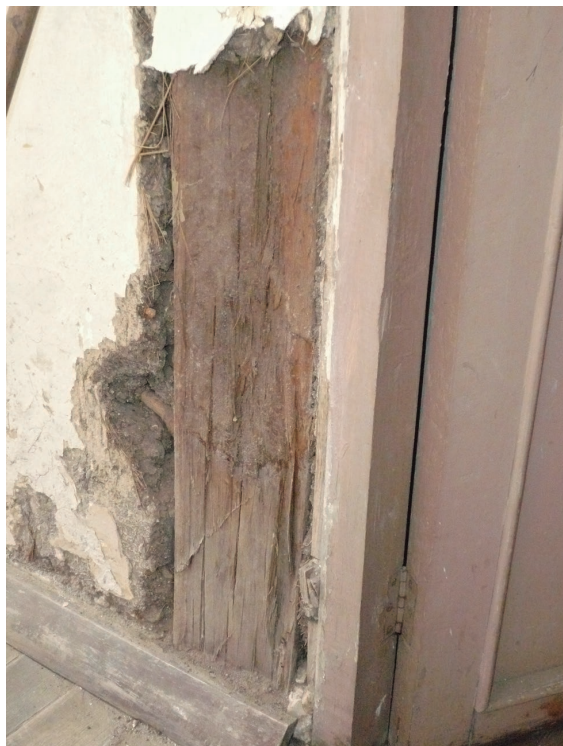
Figura 63 Desprendimiento de revoque en Planta Alta Fuente: Gabriela Bolaños Sánchez
