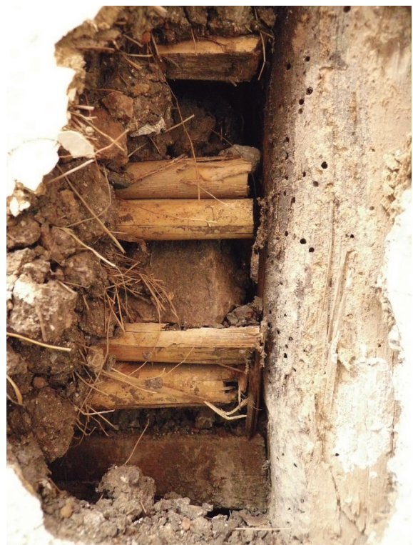
Figura 52 Cala en la pared de la Casa Sánchez Fuente: Gabriela Bolaños Sánchez
