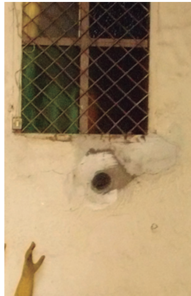
Figura 61 Acercamiento de la falla constructiva Fuente: Gabriela Bolaños Sánchez
