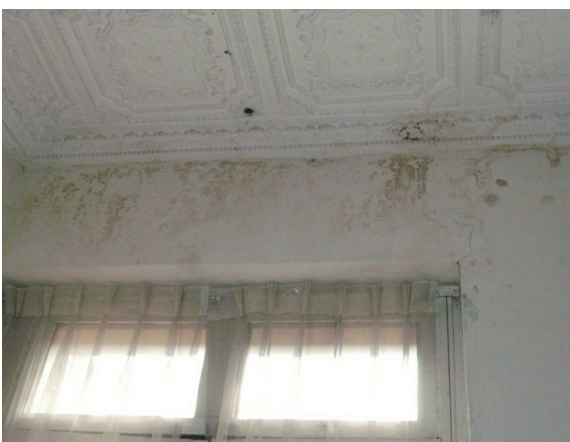
Figura 62 Presencia de humedad en muros de la sala Fuente: Gabriela Bolaños Sánchez
