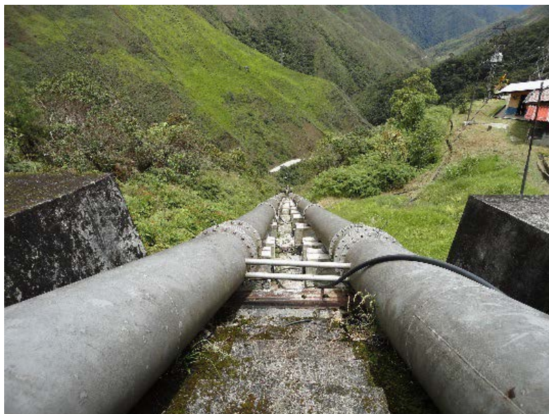
Figura 1.9 Tuberías de presión. Fuente propia
