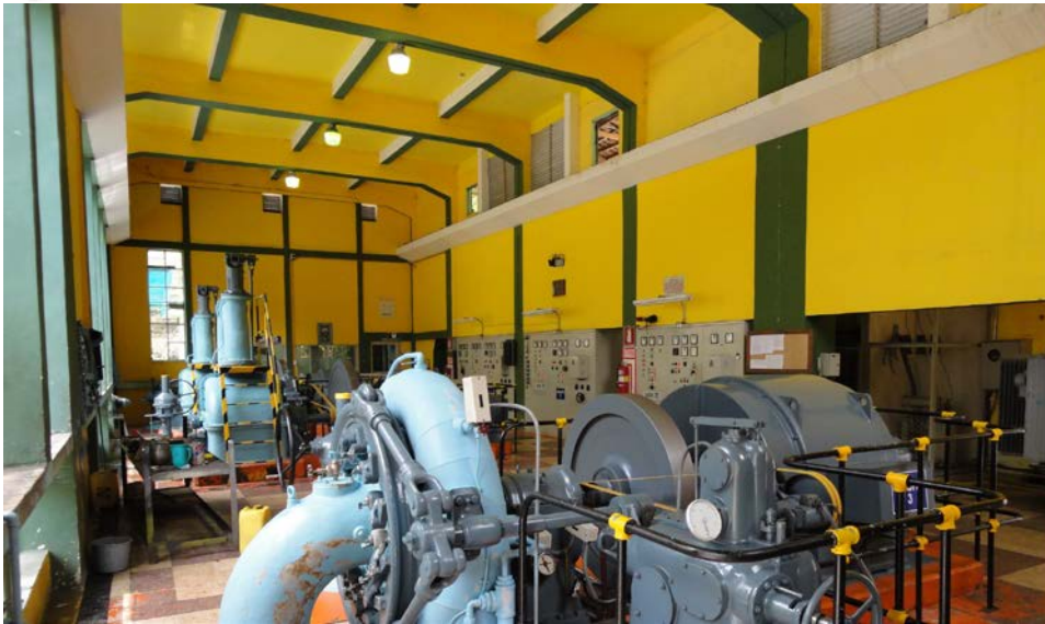
Figura 1.2 Grupos generadores de la casa de máquinas de la CCMC. Fuente propia
