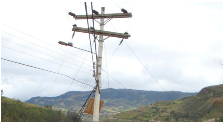
Figura 3.15 Estructura compuesta formada por dos CR+ 1 ES-044+ 2TT + 1 LUMINARIA
