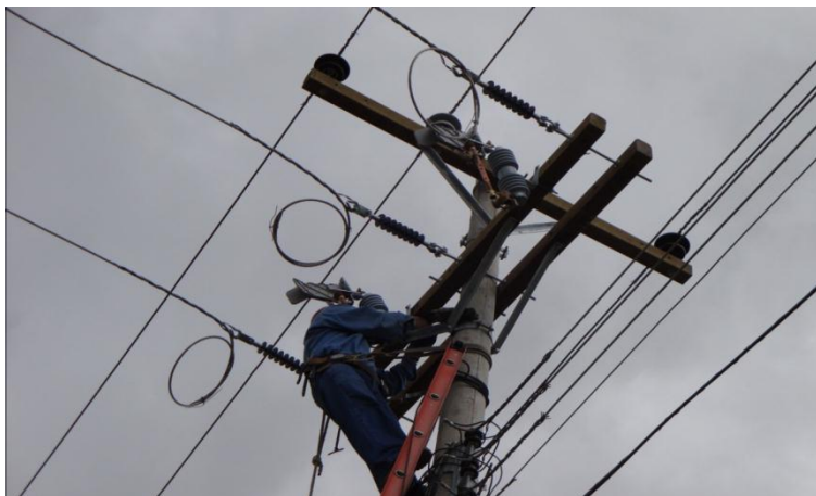
Figura 3.3 Existió una violación al trabajo, el ensamblaje debió ser ejecutado por tres personas y se lo realizó únicamente con dos personas
