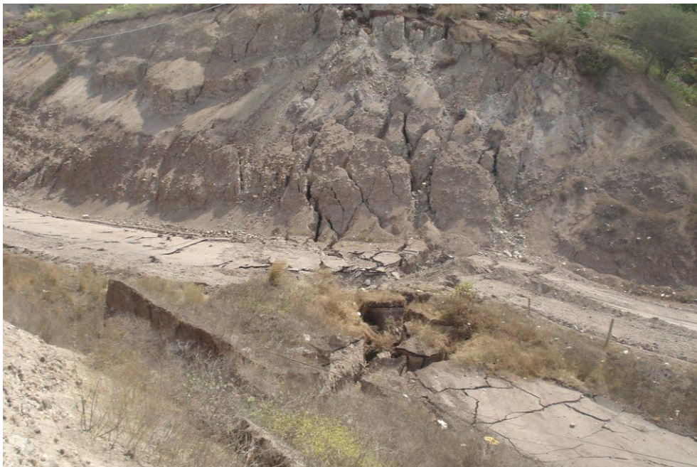
Foto 2. Daños ocasionados por el Macrodeslizamiento de Puenteloma en el año 2010
