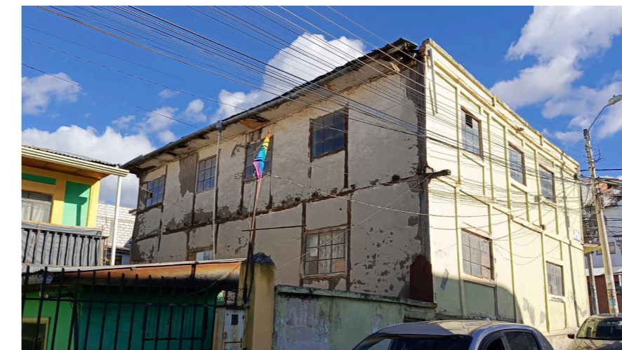
Figura 12: Vivienda de bahareque en mal estado en el centro urbano de Cañar, calle 24 de Mayo.
