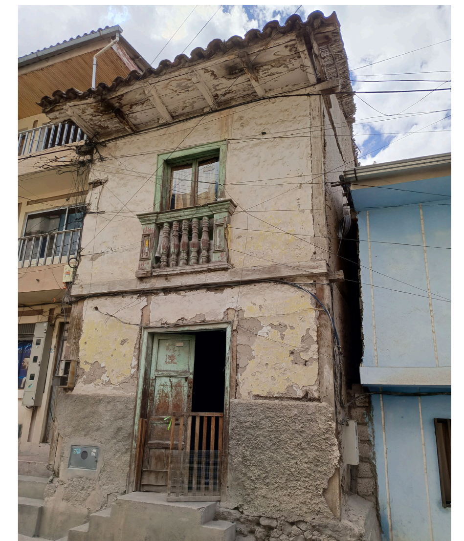
Figura 13: Vivienda de bahareque en mal estado en el centro urbano de Cañar, calle Borrero.
