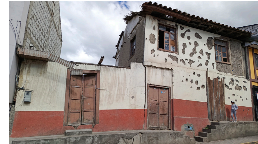
Figura 11: Vivienda de bahareque en mal estado en el centro urbano de Cañar, calle 10 de agosto.
