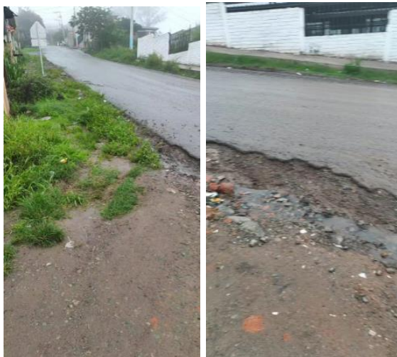
Ilustración 47. Estado de las vías. Elaboración propia.
