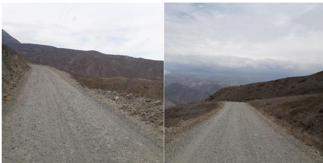
Fotografía 14: Estado Actual de la vía
