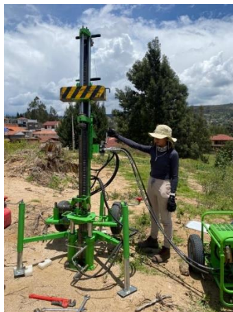
Figura 11. Equipo para perforaciones
