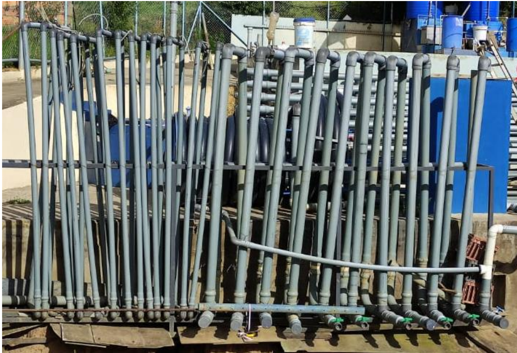
Ilustración 6. Sistema piloto de geometría vertical construido en la PTAP Bayas, obtenido de Gutiérrez, González (2022).
