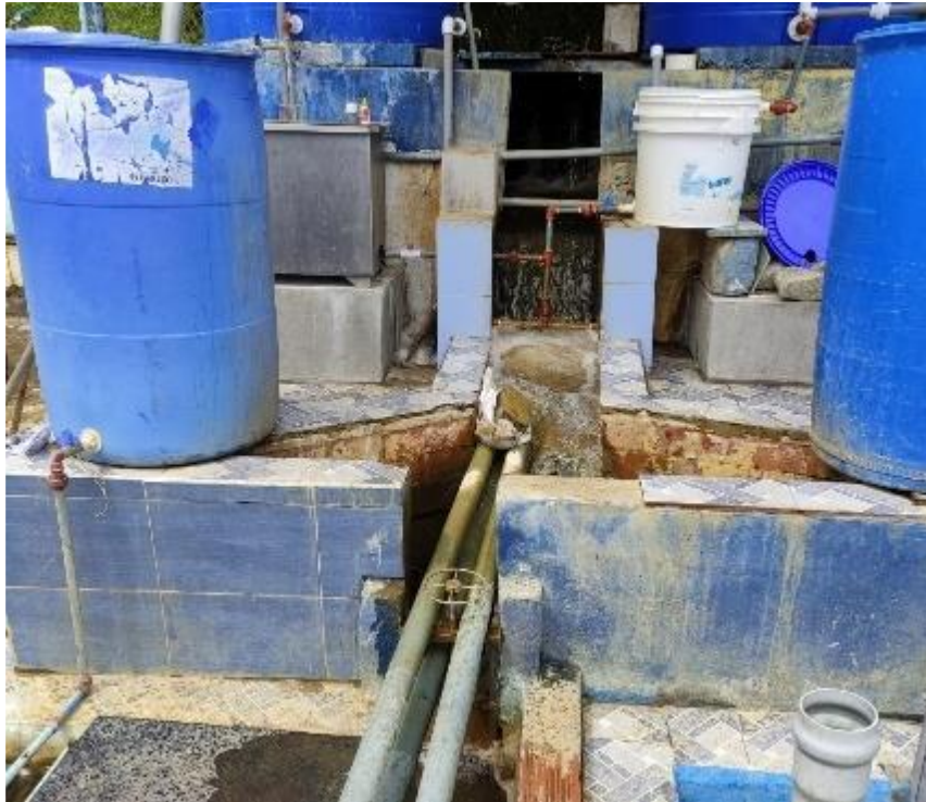
Ilustración 7. Punto de captación para el transporte de agua hacia el floculador vertical, obtenido de Gutierrez, González (2022).
