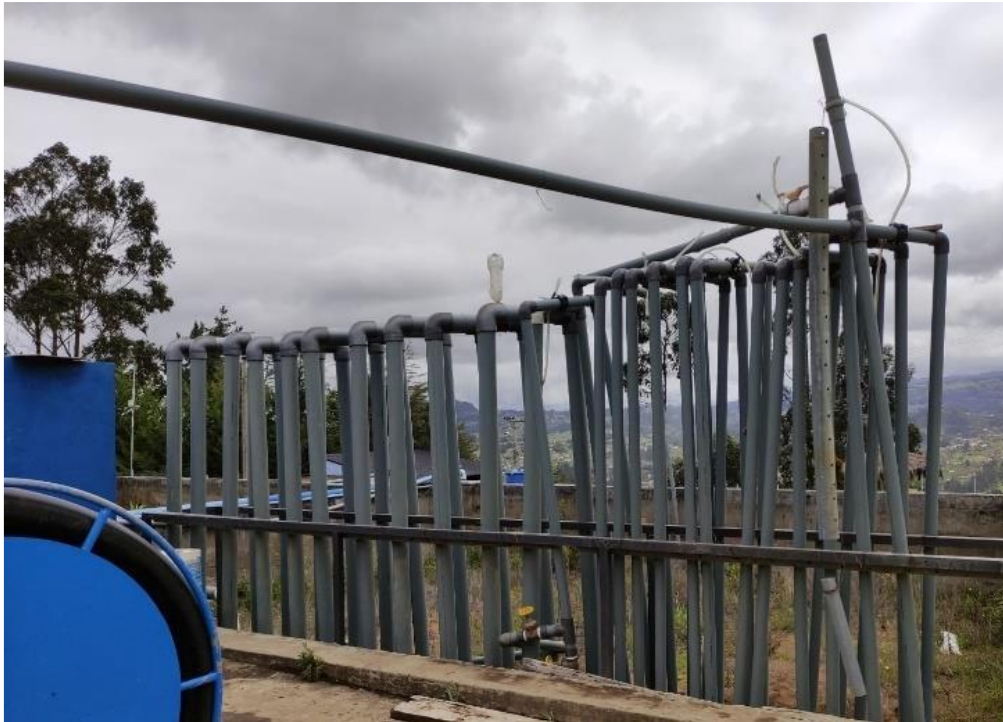
Ilustración 8. Entrada mediante una tubería de PVC de 63mm al floculador vertical, obtenido de Gutierrez, González (2022).
