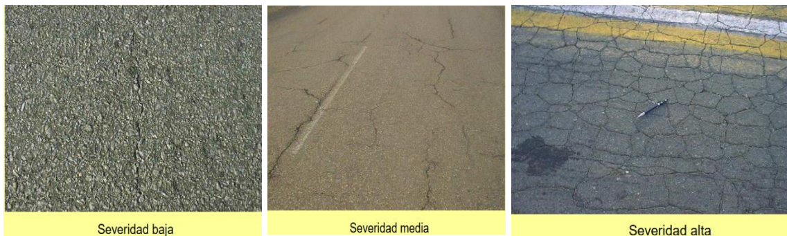
Figura 10: Piel de cocodrilo según nivel de severidad
