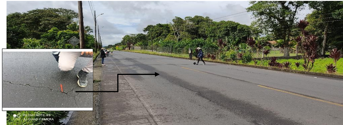
Figura 21: Fallas de la sección 3 (2+750 hasta la 6+250) de fisuras longitudinales acompañadas de piel de cocodrilo, hundimientos longitudinales, y grietas por contracción térmica.
