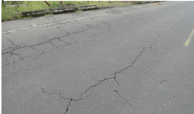
Falla piel de cocodrillo acompañado de grietas por contracción térmica en la abscisa 12+000
