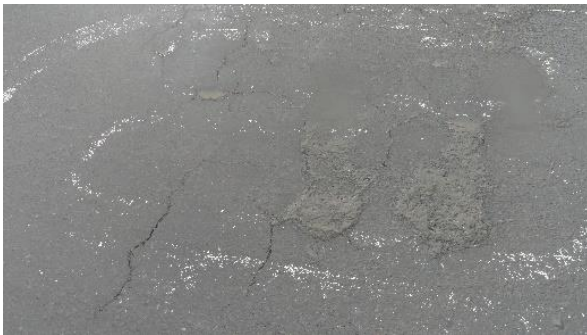
Figura 20: Falla de baches, huecos y piel de cocodrilo sobre la calzada
