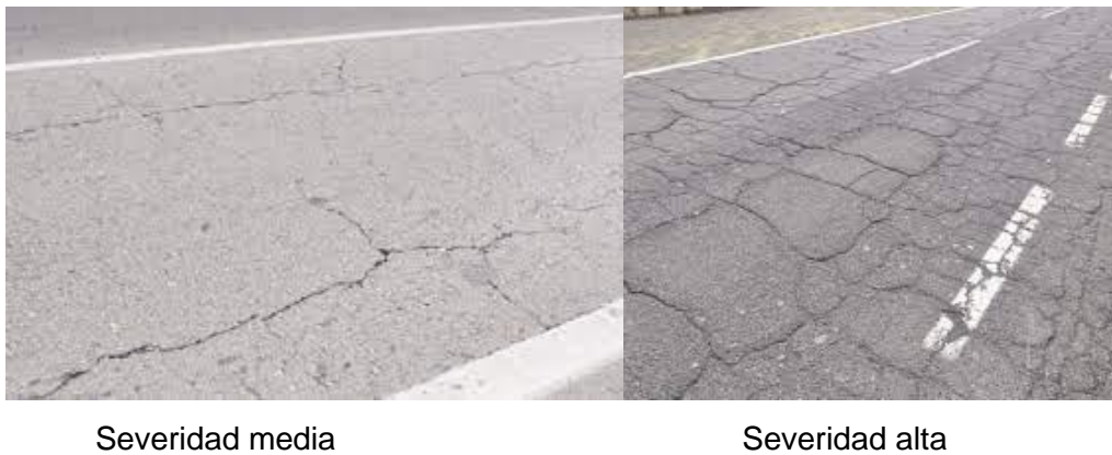
Figura 9: Fisuras en bloque según nivel de severidad
