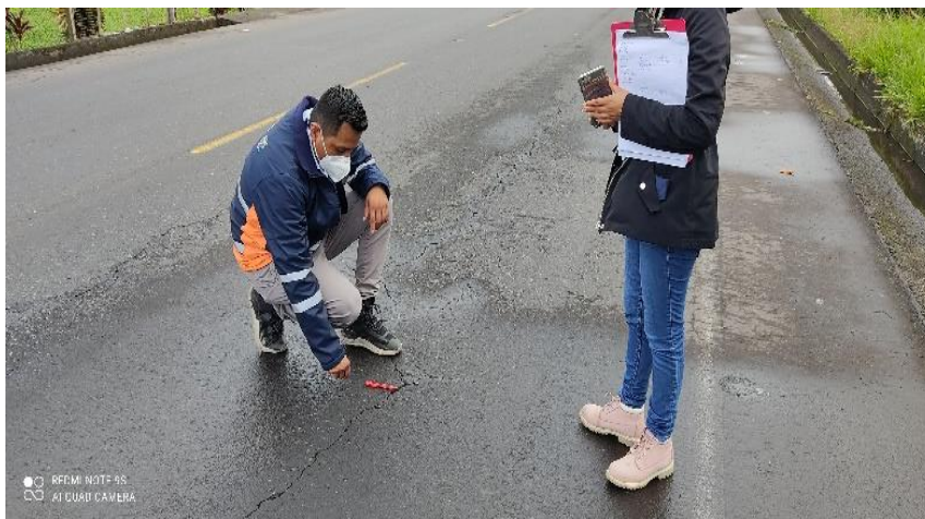
Figura 22: Fallas en la sección 4 (6+250 a 7+250) de fisuras en bloque acompañadas de piel de cocodrilo y grietas por contracción térmica.
