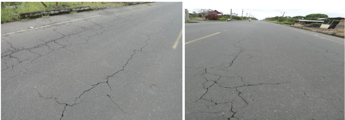
Figura 24: Falla en la sección 5 (7+500 a 10+000) de grietas por contracción térmica acompañadas de piel de cocodrilo
