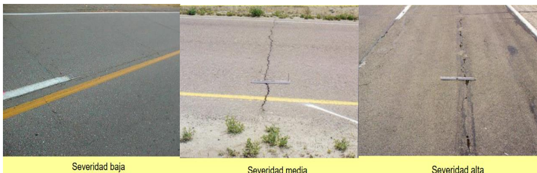
Figura 8: Grietas longitudinales según nivel de severidad
