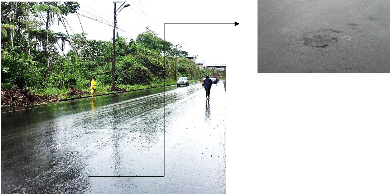
Figura 19: Fallas en la sección 2 (1+500 a 2+750) de fisuras longitudinales acompañadas de abultamientos, depresiones y piel de cocodrilo.
