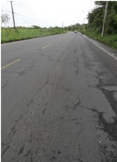
Figura 23: Fallas de piel de cocodrilo
