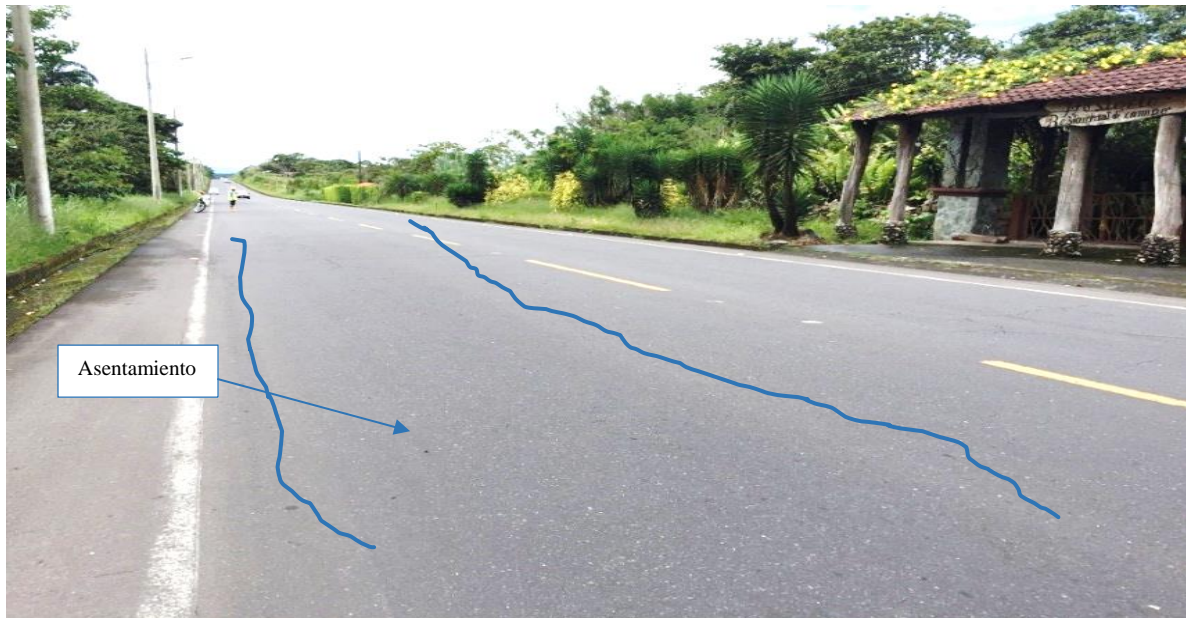
Figura 28: Fallas superficiales de la sección 8 (16+000 a 25+000) caracterizadas por piel de cocodrilo acompañado de grietas longitudinales por fatiga y ahuellamiento.
