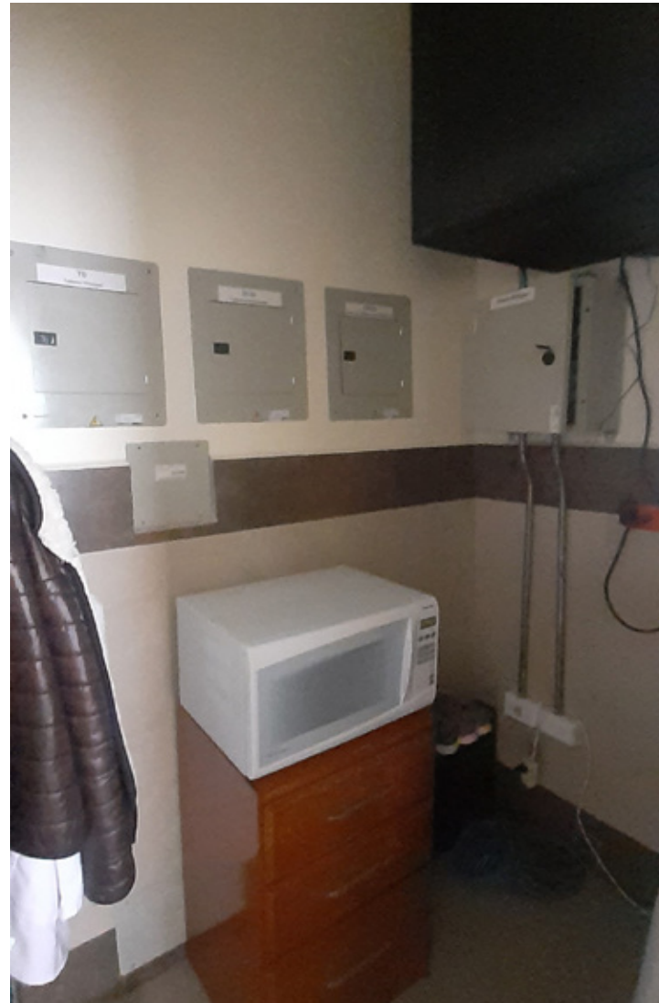
I2 Vestidor e instalaciones. Vista 1. Fuente: propia.
