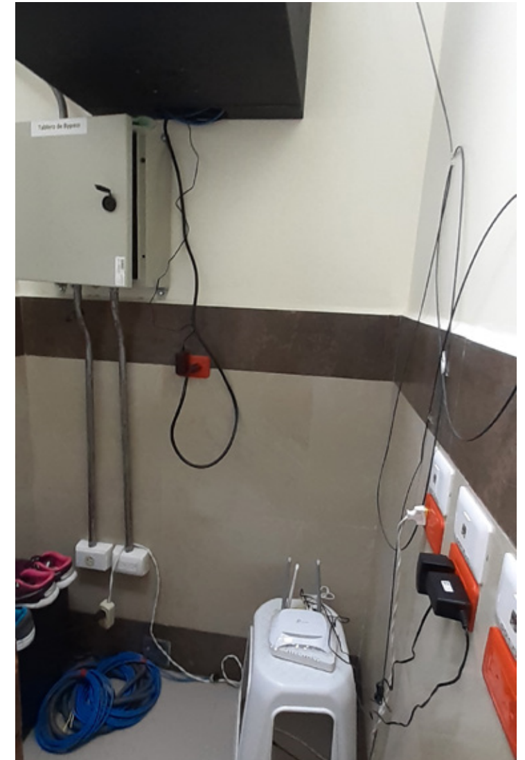
I1 Vestidor e instalaciones. Vista 2. Fuente: propia.
