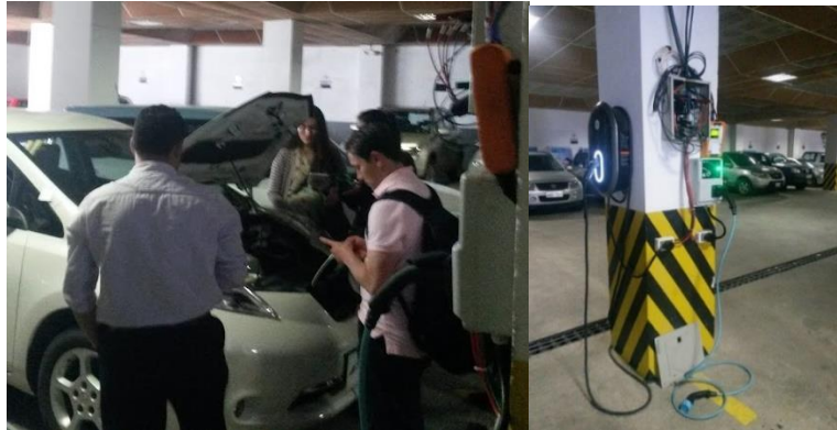
Figura 3.8. Instalación y pruebas de vehículo eléctricos.
