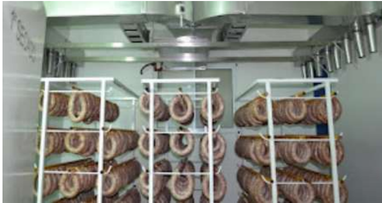
Figura 8 Cámara de maduración y secado
