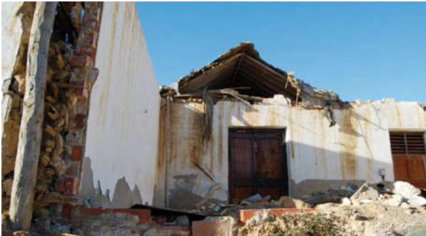
FIG. 5. DERRUMBE CAUSADO POR EL USO DE RECUBRIMIENTOS DE CEMENTO EN UNA VIVIENDA PATRIMONIAL DE BAJAREQUE, LA VELA - VENEZUELA. ARCHIVO DEL AUTOR,
