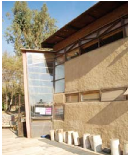
FIG. 7. EL TEATRO DE QUINCHA METÁLICA DISEÑADO POR EL ARQUITECTO MARCELO CORTÉS EN PEÑALOLÉN, CHILE RESISTIÓ SIN DAÑOS LOS TERREMOTOS SUFRIDOS EN 2006 Y 2010 CON MAGNITUDES DE 7.7 Y 8.8 GRADOS RESPECTIVAMENTE. (ARCHIVO DEL AUTOR)
