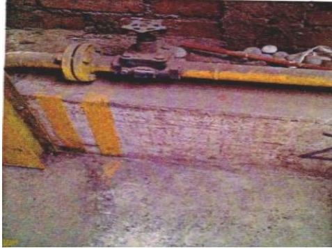
Fotografía 5: Líneas de distribución de GLP
