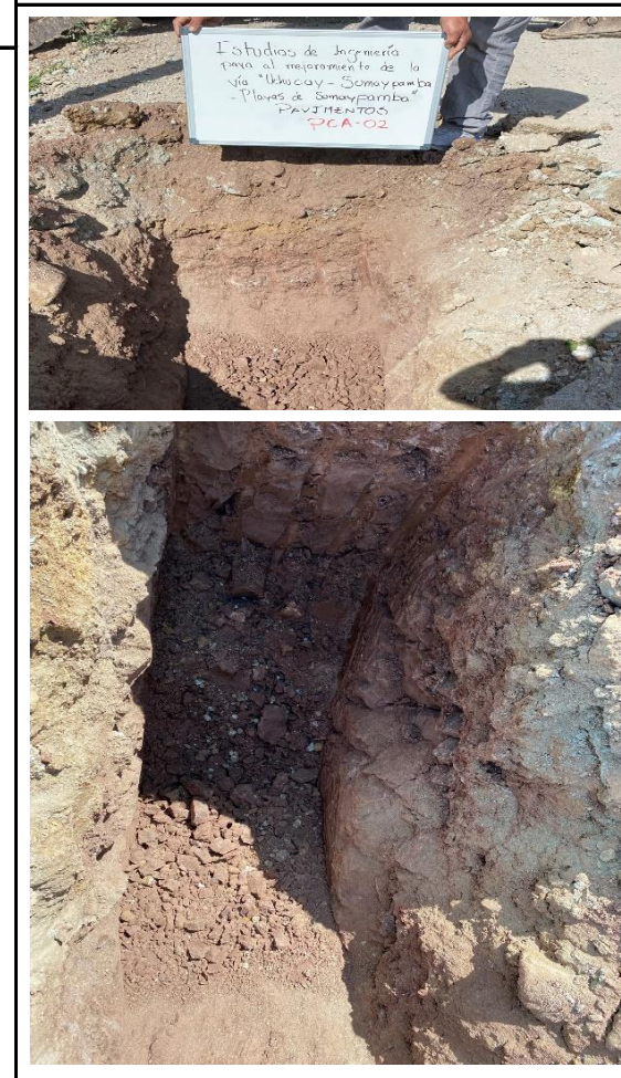
Foto 1: Indica los materiales encontrados en la PCA # 02
