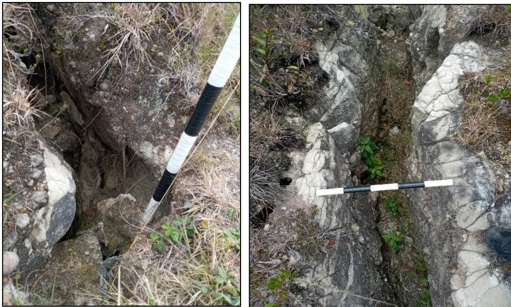
Imagen 16: Fisura desproporcionada y desgaste de sus laterales por acción del agua
