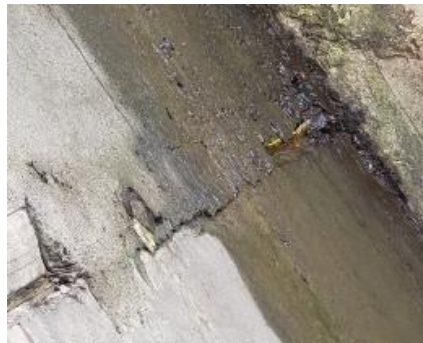
Gráfico 38 Desprendimiento de hormigón y cinta PVC expuesta.
