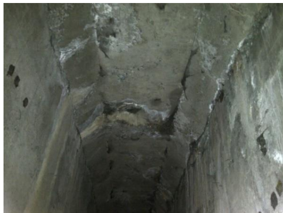
Gráfico 18 Eflorescencias por filtraciones de agua.
