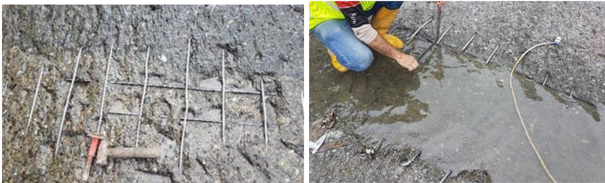
Gráfico 5 Varillas expuestas y con pérdida de sección.
