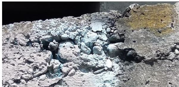
Gráfico 48 Segregación y hormigueros en uno de los arcos.
