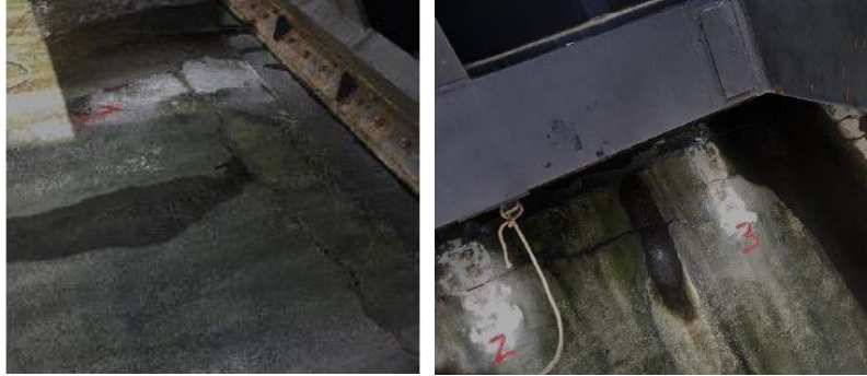
Gráfico 33 Grieta horizontal (la grieta es paralela a la compuerta).
