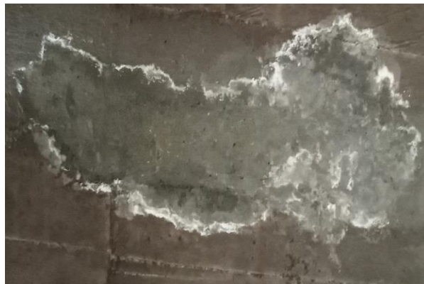
Gráfico 51 Eflorescencia causada por la humedad que se filtra desde la calzada.
