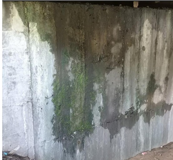
Gráfico 49 Humedad en estribo del puente.
