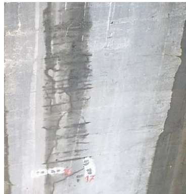
Gráfico 37 Fisuras tipo piel de cocodrilo.
