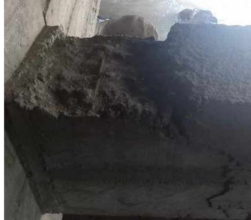
Gráfico 52 Daño importante en una de las vigas de arriostramiento.
