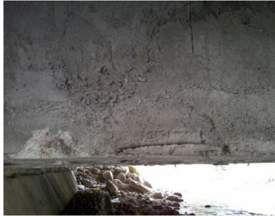
Gráfico 15 Segregación en una de las vigas del puente.
