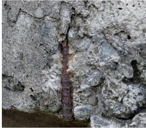
Gráfico 46 Varilla expuesta y con corrosión ubicada en el costado del tablero.
