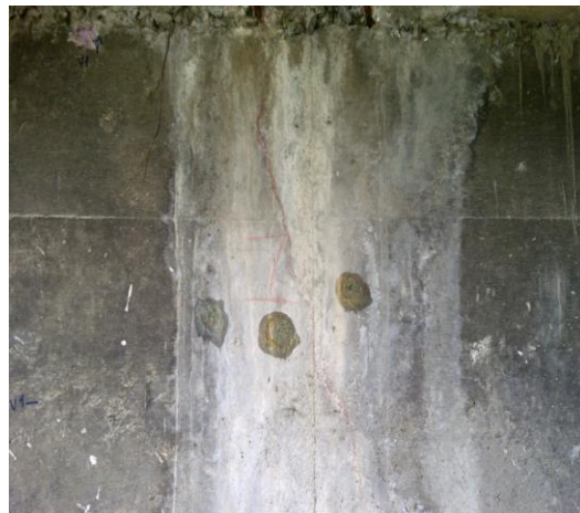
Gráfico 17 Grieta vertical que atraviesa el elemento.
