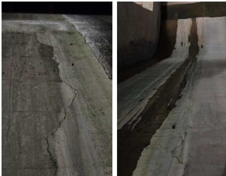
Gráfico 35 Junta de construcción sin inducir corte en el vertedero central.
