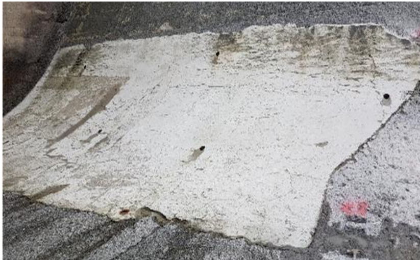
Gráfico 7 Recubrimiento en mal estado.
