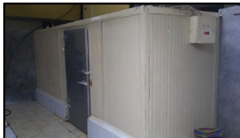
Imagen 30. Cámara de frío.
