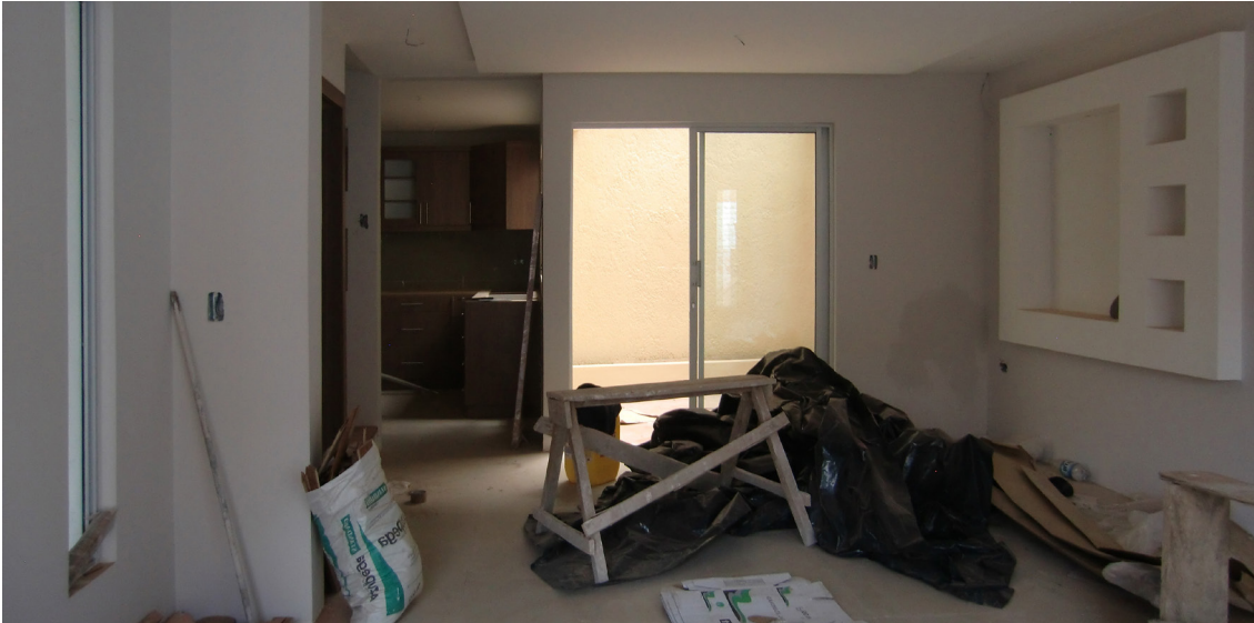
Vistas de espacios diagnosticados, paredes.
