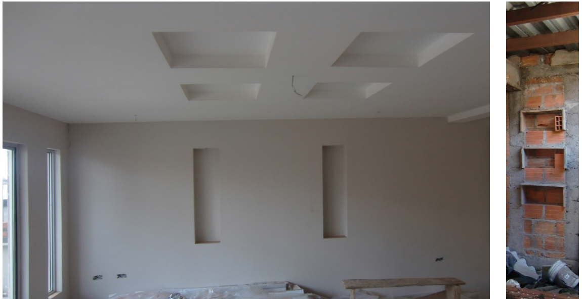
Vistas de espacios diagnosticados, paredes.
