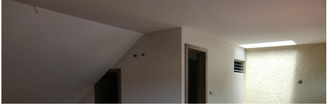
Vistas de espacios diagnosticados, cielo raso.
