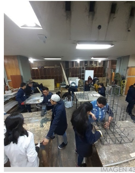
Imagen 43: Trabajo en taller "etapa de fabricación de zapatas". Hermida, Patiño, 2019. Gráfico 41: Esquema de armadura para plinto de zapata. Gráfico 42: Esquema de malla para parrilla de zapata. Gráfico 43: Esquema de plinto prefabricado. Hermida, Patiño, 2021.
