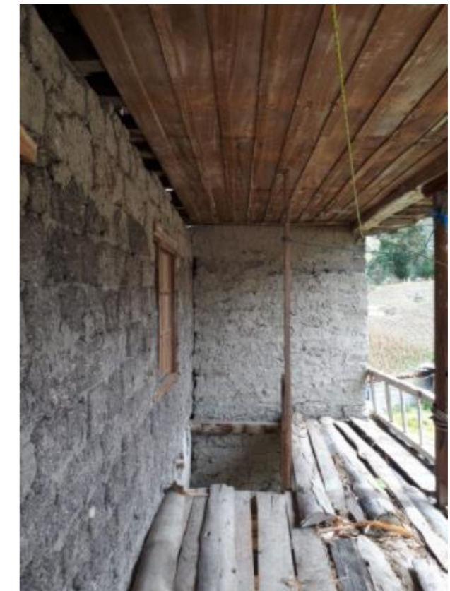
Fotografía3. 31. Pisos y cielorraso de la vivienda
