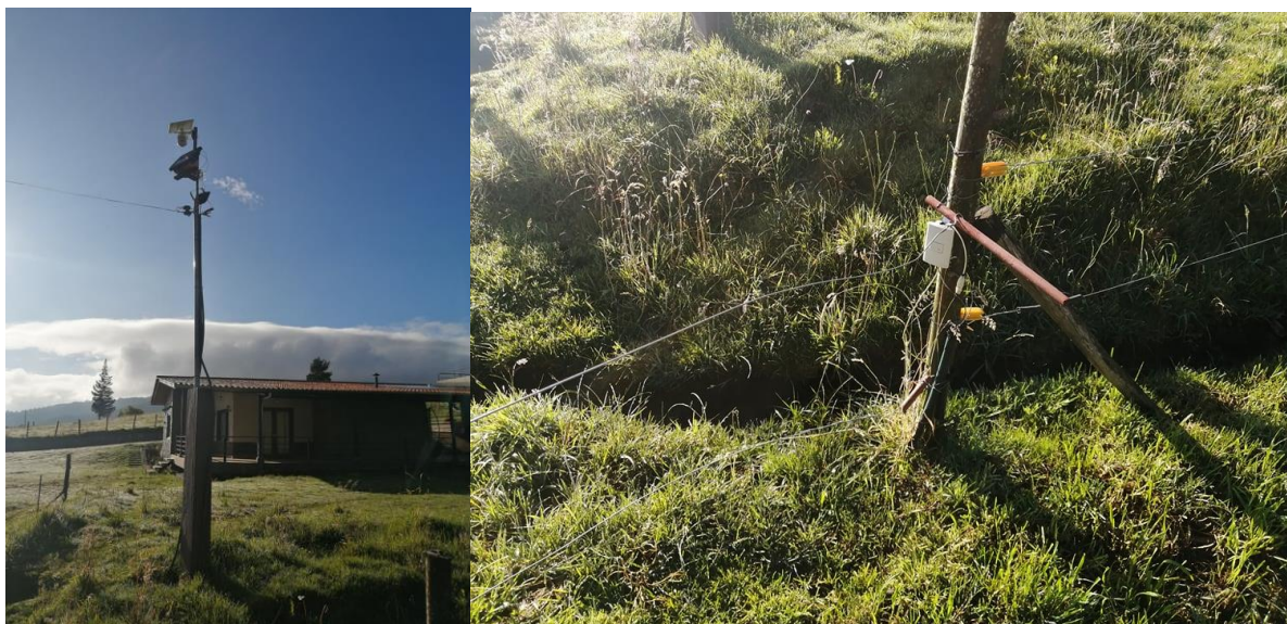
Ilustración 30 Cercado eléctrico, panel solar y sistema de vigilancia.
