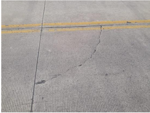
Figura 3.52. Grieta de Esquina.
