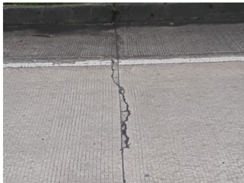
Figura 3.56. Despostillamiento de junta.
