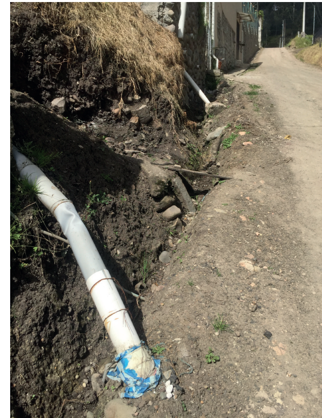
Fotografía 47: Filtraciones al exterior de aguas servidas.
