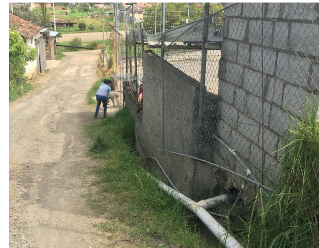
Fotografía 60: Instalaciones hidrosanitarias expuestas al ambiente.
