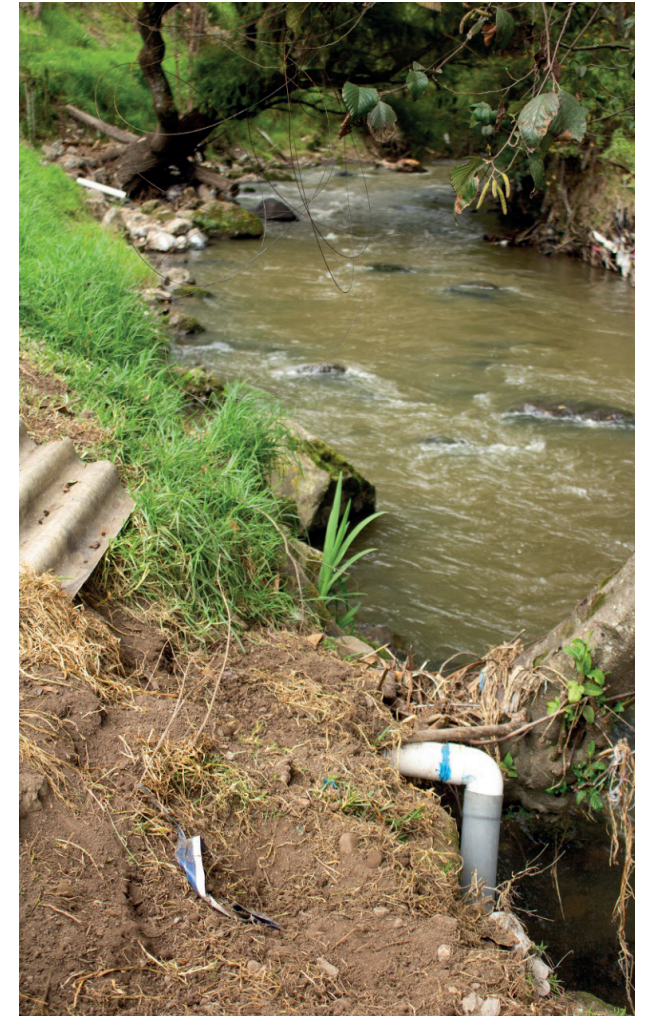
Fotografía 61: Desalojo directo de aguas servidas en el río Tarqui.
