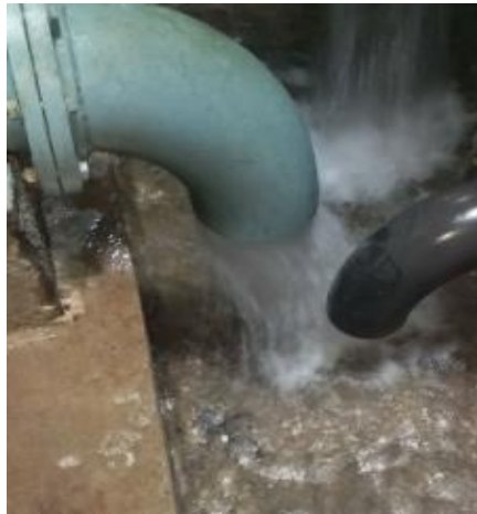
Imagen 32 Toma de fugas en las tuberías. Fuente: Elaboración-Autor
