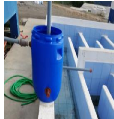
Imagen 38 Tanque dosificador de polímero Fuente: Elaboración-Au
