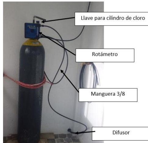
Imagen 10 Dosificador de cloro gas Fuente: Elaboración-Autor
