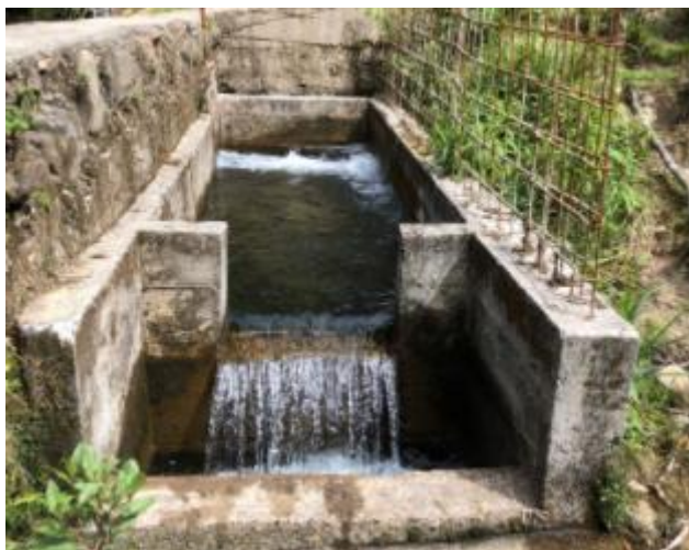
Imagen 3 Captación en el río Minas Fuente: Elaboración-Autor
