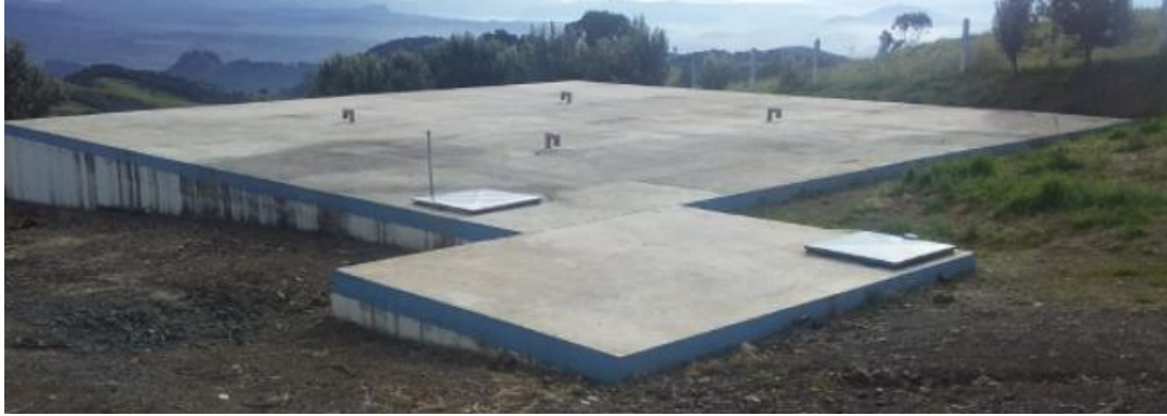
Imagen 8 Unidad de almacenamiento de agua tratada Fuente: Elaboración-Autor
