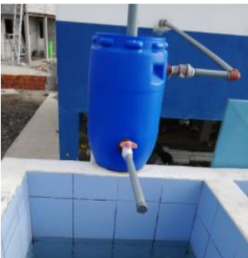
Imagen 36 Tanque de dosificación de regulante de pH Fuente: Elaboración-Autor
