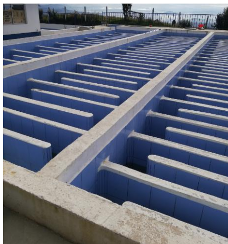
Imagen 6 Canaletas de Parshall
