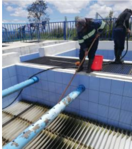
Imagen 41 Limpieza de unidades de tratamiento. Fuente: Elaboración-Autor
