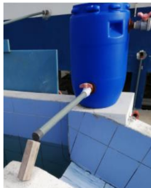
Imagen 37 Tanque de dosificación de Sulfato de Aluminio Fuente: Elaboración-Autor
