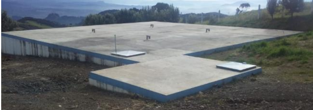
Imagen 12 Unidad de almacenamiento de agua tratada Fuente: Elaboración-Autor
