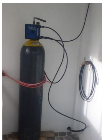
Imagen 10 Tanque de Cloro Gas Fuente: Elaboración-Autor
