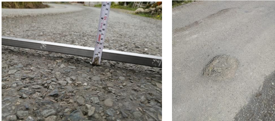
Figura N° 19. Fallas de la vía Ricaurte-Llacao (izquierda desgaste, derecha baches).
