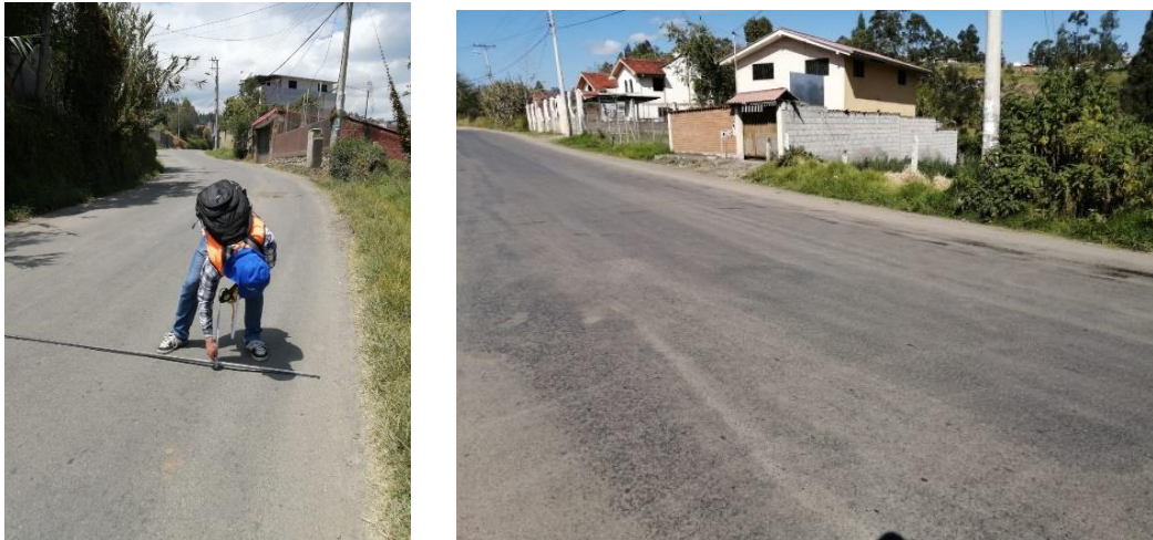
Figura N° 20. Fallas en la vía Monay-El Valle (izquierda Ahuellamiento, derecha depresiones).
