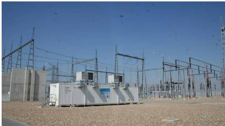
Figura 2.10 Batería de Ion-litio instalada en la subestación de transporte de Carmona (Sevilla) [15]
