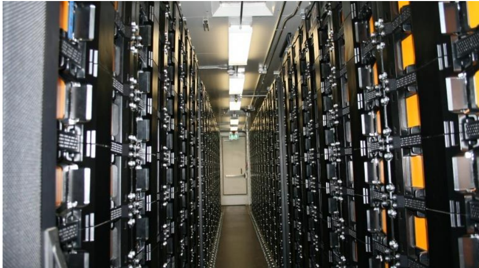
Figura 2.11 Interior de la batería de Ion-litio instalada en la subestación de transporte de Carmona (Sevilla). [15]
