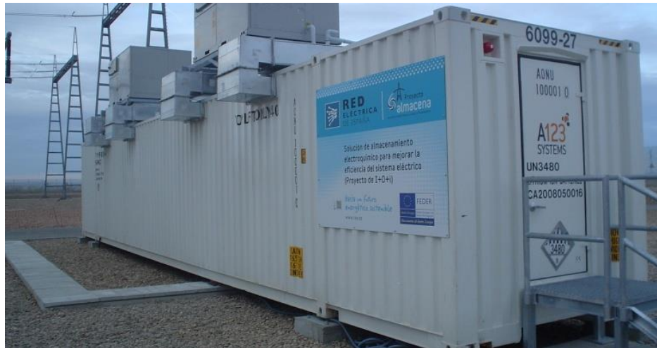
Figura 2.9 Almacenamiento de energía mediante baterías de Ion-Litio en Carmona. (Fuente: REE 7 )[15]
