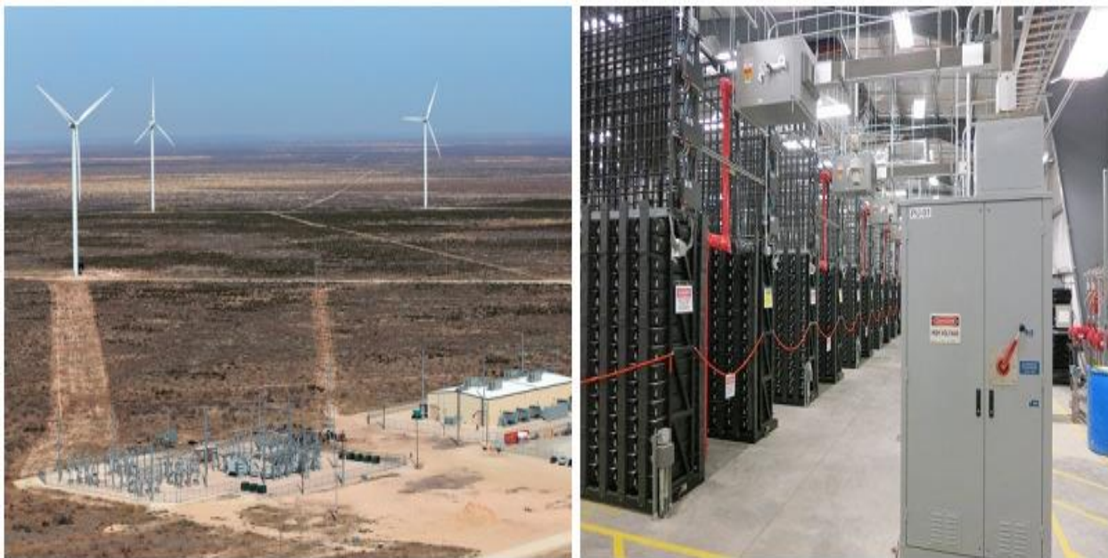
Figura 2.13 Sistema de almacenamiento mediante baterías de Plomo-Acido [22]
