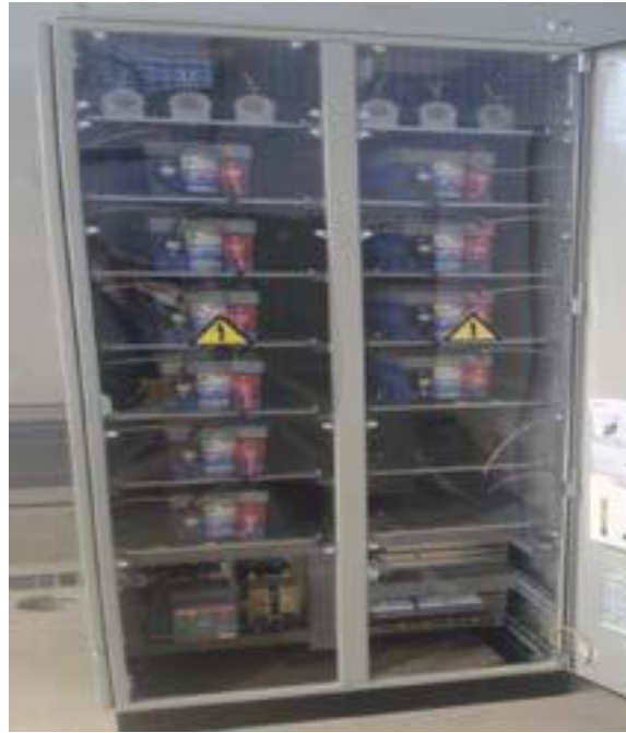
Figura 2.6 Supercondensadores Maxwell de 130 F c/u perteneciente a laboratorio de Microredes de la Universidad de Cuenca, sector Balzay. (Fuente: Elaboración propia)
