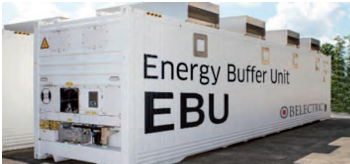
Figura 4.1 Sistema modular de baterías en una planta solar Alt Daber Alemania. [35]
