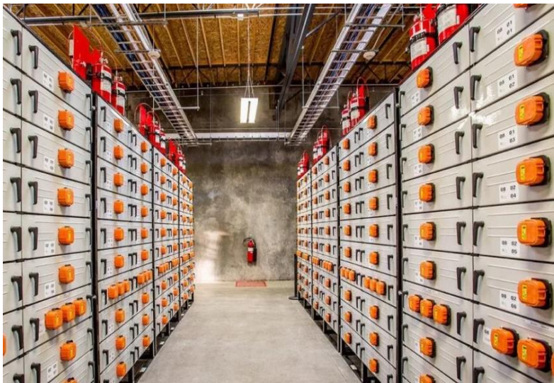
Figura 2.12 Disposición de baterías para el almacenamiento de energía mediante baterías de Ion-Litio. [18]
