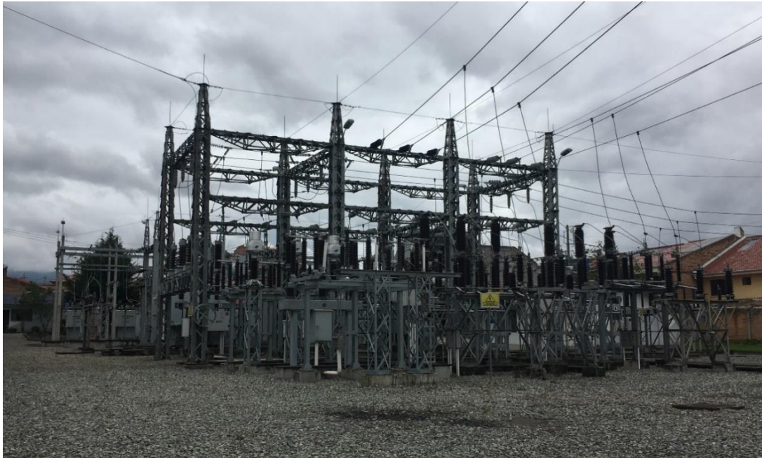
Figura 1.3 Subestación 5 perteneciente a la Empresa Eléctrica Regional Centro Sur (Fuente: Elaboración propia)
