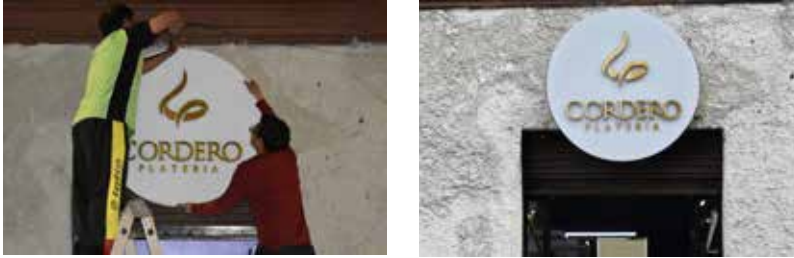
Imagen 33. Letrero. Colocación del letrero en la fachada de la joyería. Autor: Katherine Cordero
