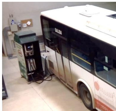
Figura 5.9. Estación de Carga del fabricante BYD.
