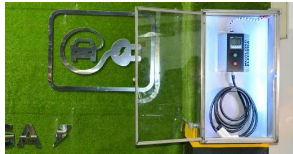
Figura 2.14. Primera Estación de Carga Pública en la ciudad de Cuenca.
