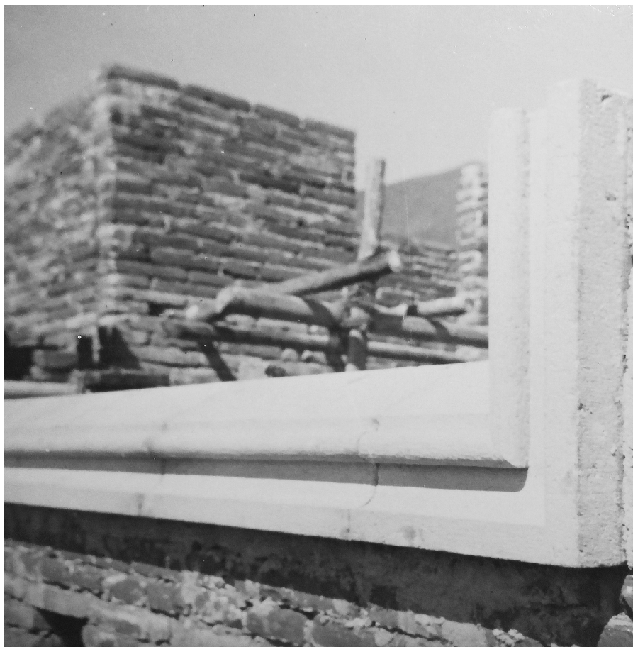
fig.242. Detalle constructivo de piezas modulares prefabricadas de piedra de marcos de ventanas / También se observa la construcción de los muros con ladrillo macizo
