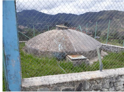
Fotografía 5. Tanque de almacenamiento ubicado en Sisapamba.
