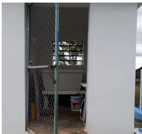
Fotografía 2. Caseta de cloración
