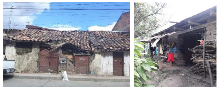
Figura 2 Construcciones de tierra en malas condiciones en la ciudad de Cuenca, Ecuador. Fuente: Autor.
