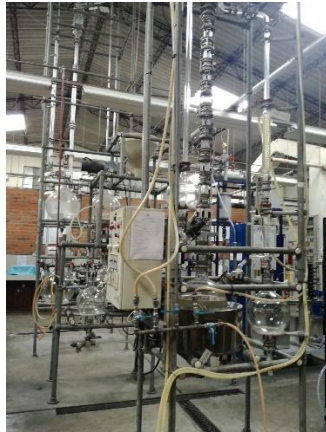
Ilustración 38: Equipo de Rectificación
