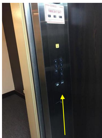
Fotografía 18: Tablero de Control Interno, Rioné Hotel Boutique
