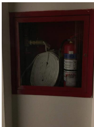
Fotografía 43: Extintores, Rioné Hotel Boutique
