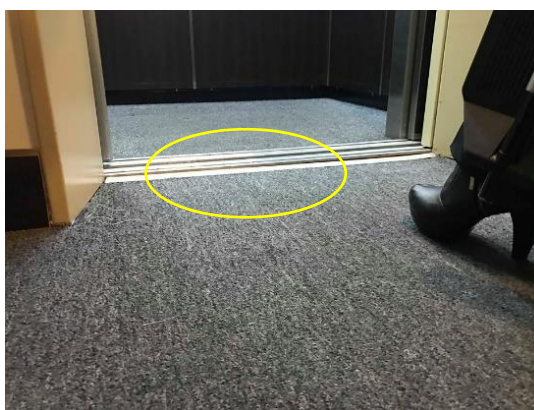
Fotografía 15: Desnivel Piso 1, Rioné Hotel Boutique
